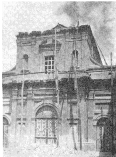
Figura 7. Capilla del Hospital San Pedro después del sismo del 14 de Julio de 1947.
