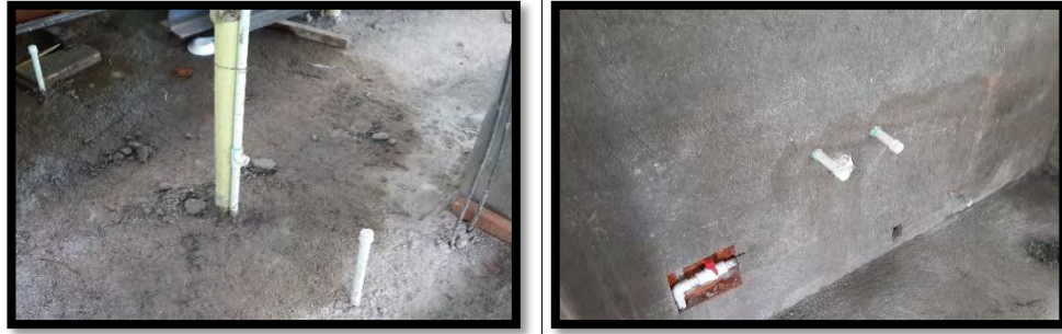
Figura 22. Punto hidráulico de 1/2" PVC.
