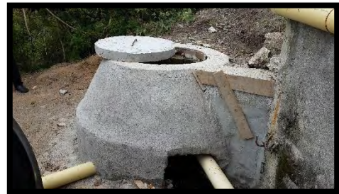
Figura 71. Cámara de inspección.
