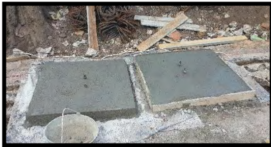
Figura 95. Cajas de inspección.
