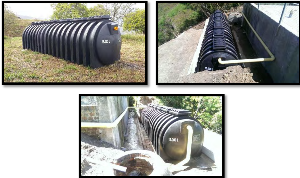
Figura 69. Sistema de tratamiento para agua residual doméstica.
