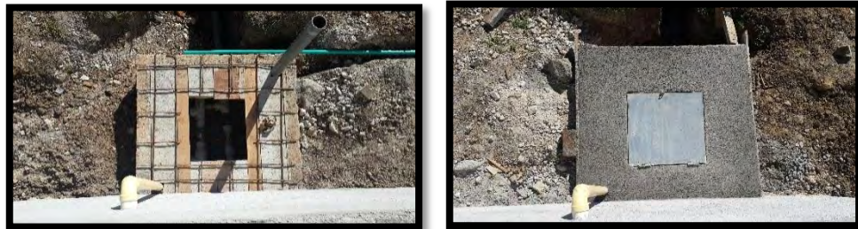
Figura 43. Cajillas de entrada y salida tanques de almacenamiento.
