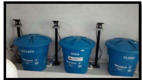
Figura 54. Tanques de suministro de químicos y bombas peristálticas.
