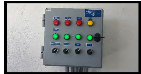
Figura 56. Tablero eléctrico PTAP.
