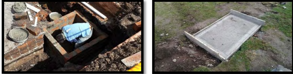
Figura 26. Cajas de inspección.
