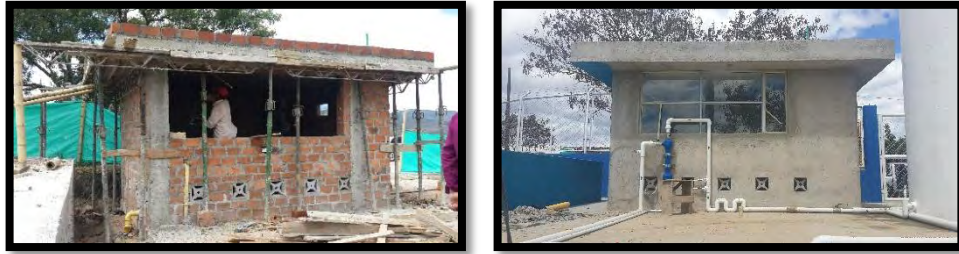
Figura 50. Caseta de suministro de químicos.
