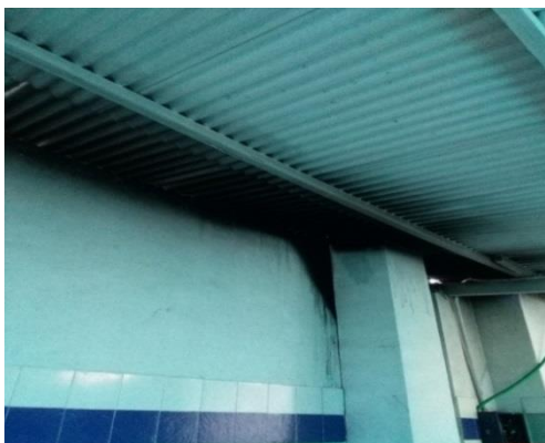
Figura 9. Estado de techos y paredes de la empresa
