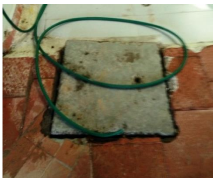
Figura 10. Estado pisos de la empresa
