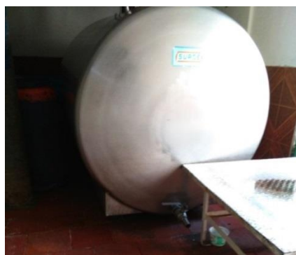
Figura 12. Tanque de almacenamiento
