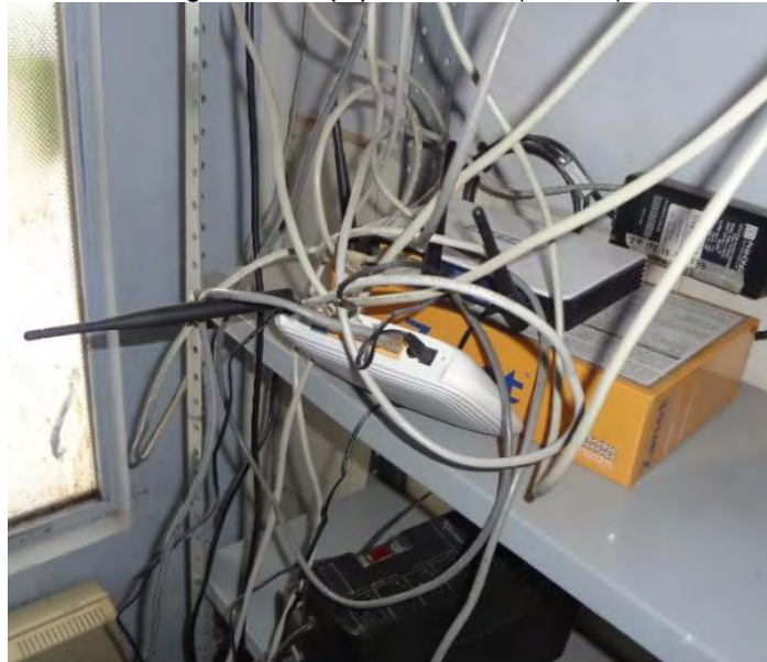
Figura 29. Equipos activos (routers)
