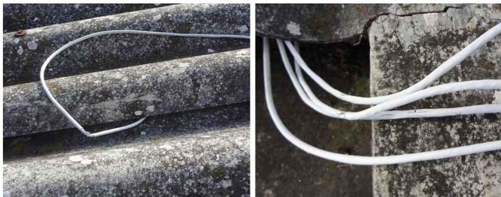
Figura 38. Daños en el cableado de red externo
