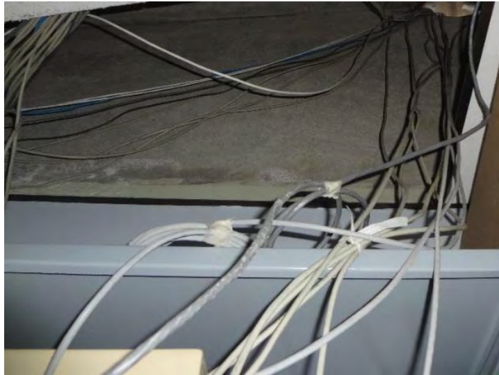
Figura 27. Switch principal de la red de datos
