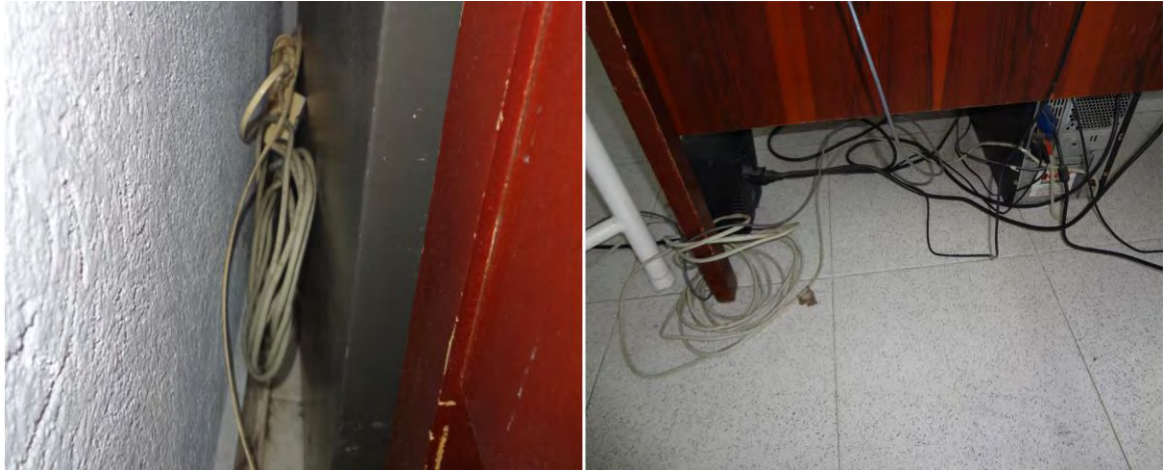
Figura 33. Exceso y desorden en cableado de red
