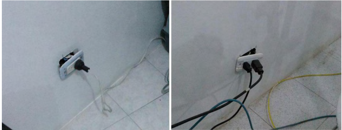
Figura 23. Tomacorrientes sin empotrar totalmente
