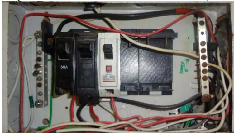
Figura 17. Tablero de distribución E – Pasillo sala de partos
