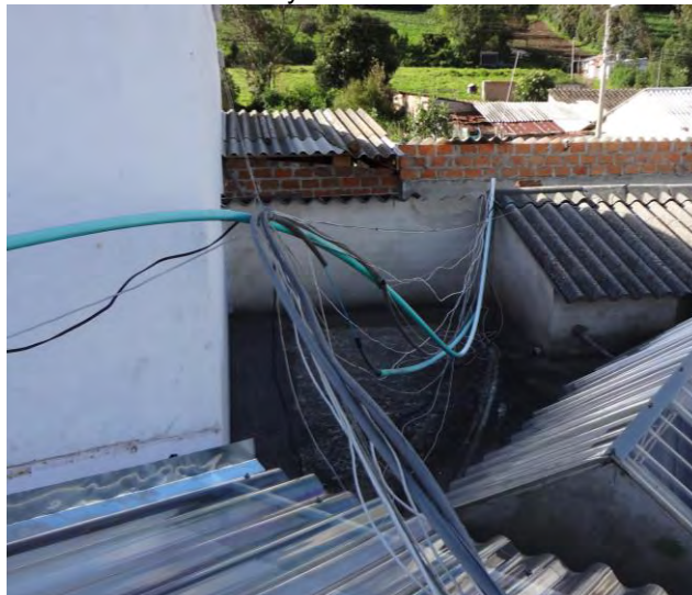
Figura 18. Conductores eléctricos y cableado de red de datos – Planta superior
