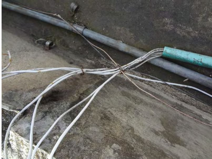
Figura 37. Cableado de red externo sin canaleta
