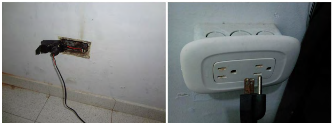
Figura 24. Tomacorrientes con daños físicos
