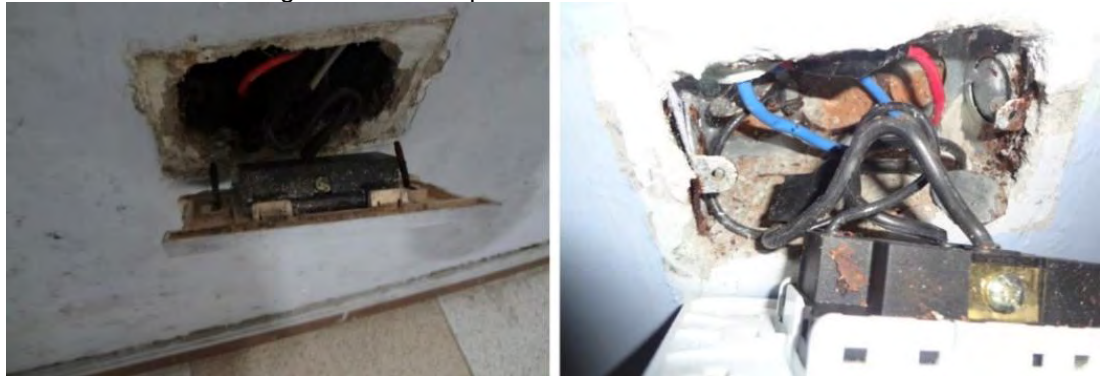
Figura 25. Daños por oxidación en tomacorrientes
