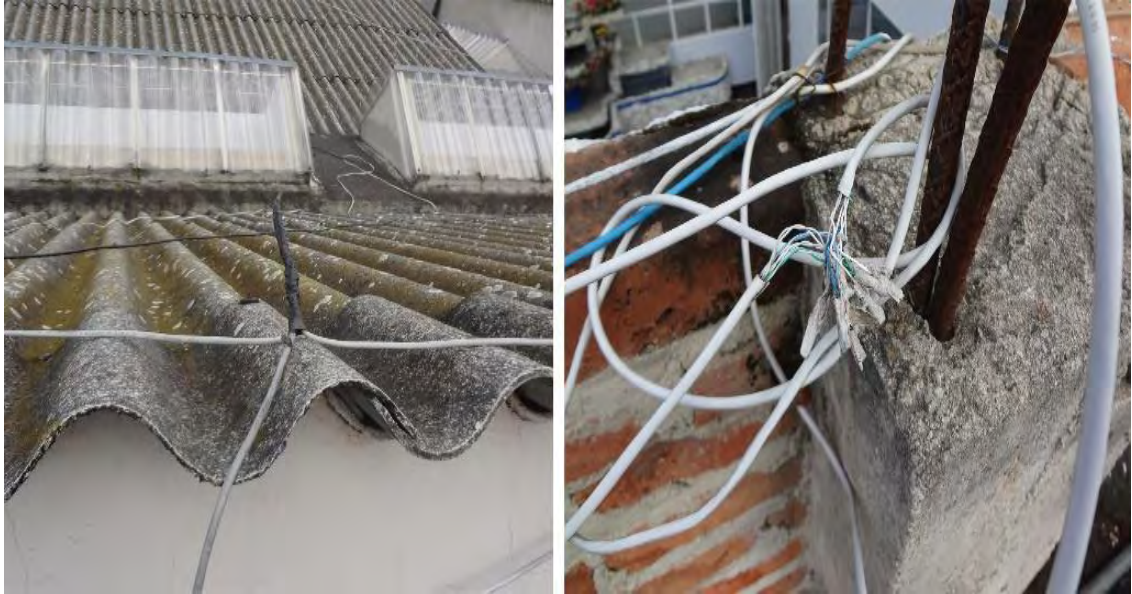
Figura 35. Empalmes en el cableado de red
