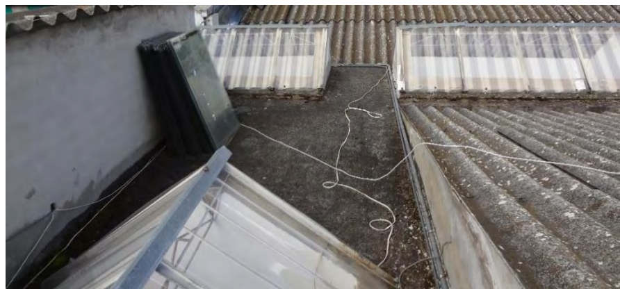
Figura 20. Conductores eléctricos sin canalización - Planta superior
