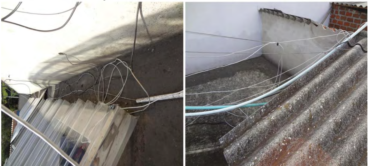
Figura 36. Cableado de red externo sin canaleta
