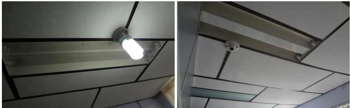
Figura 26. Luminarias sin uso
