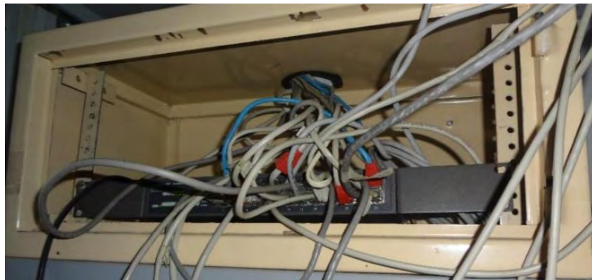
Figura 28. Switch principal de la red de datos
