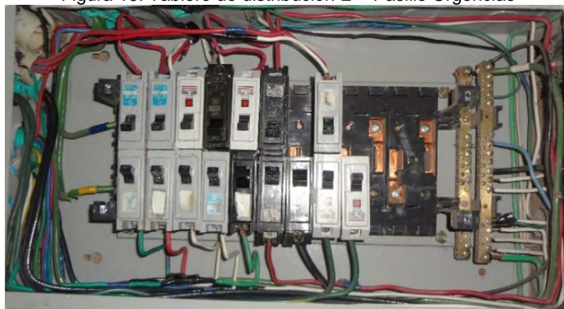
Figura 16. Tablero de distribución E – Pasillo Urgencias
