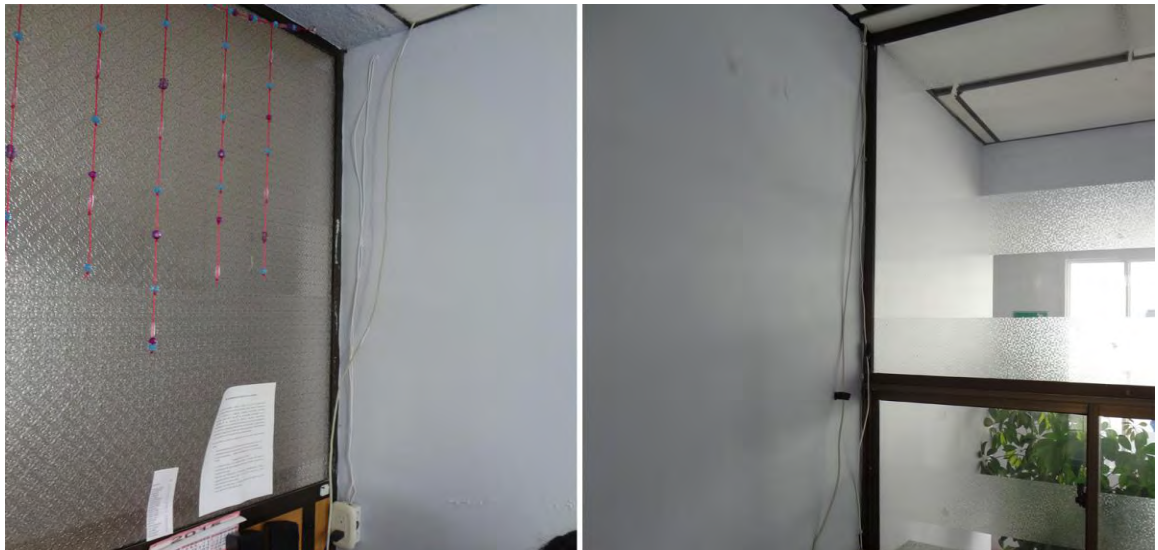
Figura 34. Cableado de red interno sin canaleta
