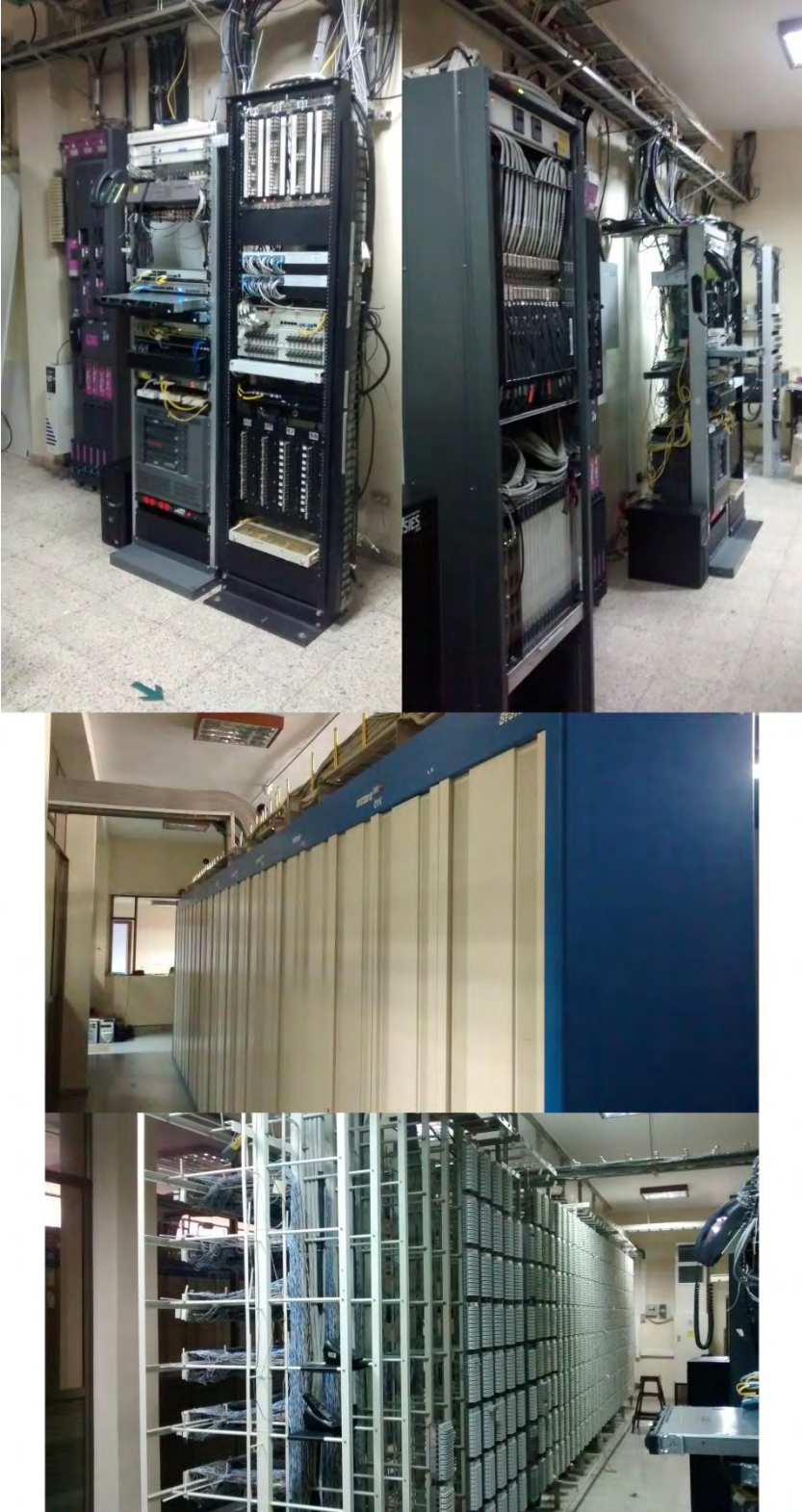
Figura 11: Imágenes planta interna Unimos S.A. E.S.P.
