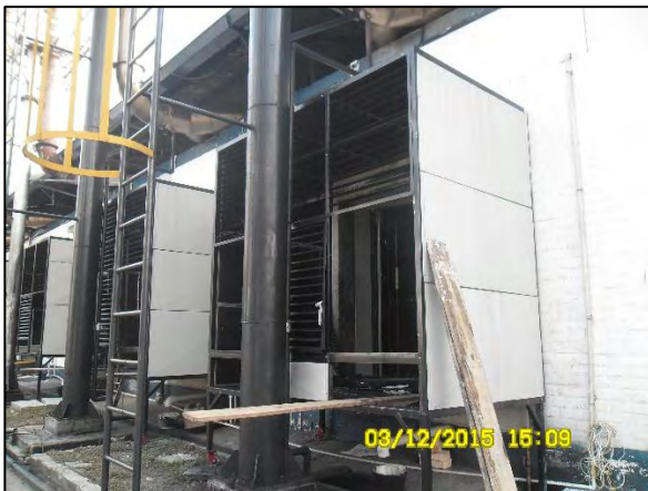
Ilustración 54 Amortiguador de ruido y salida de aire del generador 1
