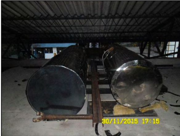
Ilustración 52 Aislamiento térmico de silenciadores de escapes
