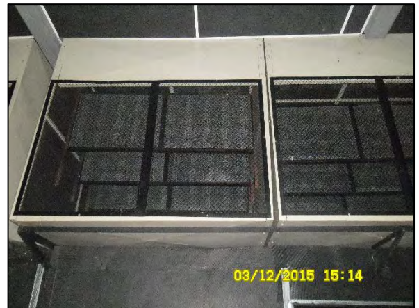
Ilustración 55 Amortiguador de ruido y entrada de aire visto desde dentro de la cabina
