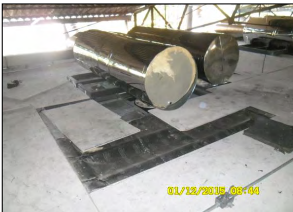
Ilustración 59 Daño en cubierta sobre el generador 4
