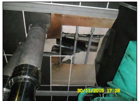
Ilustración 60 Daño en cubierta sobre el generador 3
