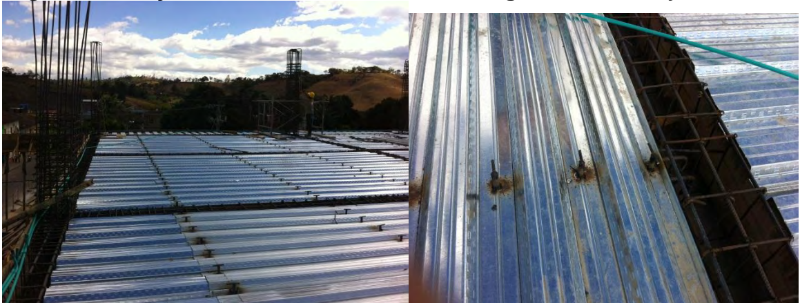
Fotografía 11. Instalación de MetalDeck 2" calibre 22 espesor 10 cm en el segundo nivel y conectores 3/4" C/30cm sobre viguetas IPE-240 y 260
