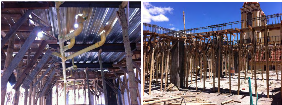
Fotografía 12. Instalaciones hidrosanitarias segundo nivel y Armado de canastillas para columnas y vigas segundo Nivel N+7.40m
