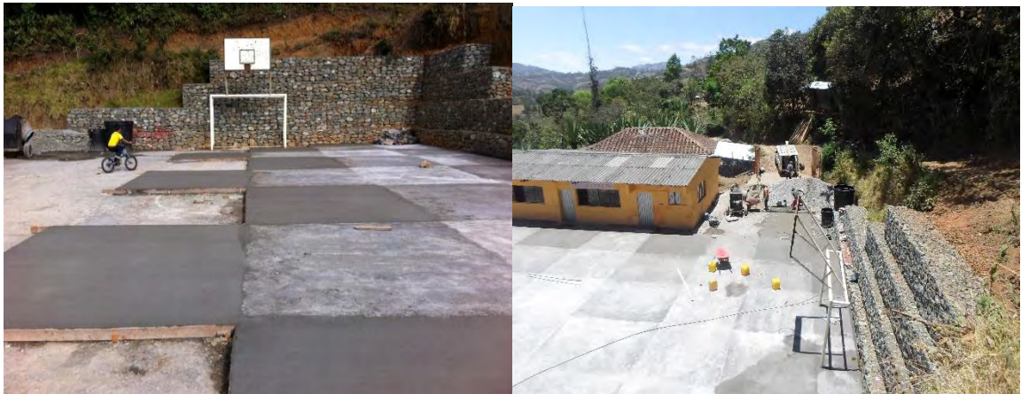
Fotografía 68. Recalce en concreto hidráulico de 8cm con malla electrosoldada de cancha multifuncional en la vereda de La Sultana.
