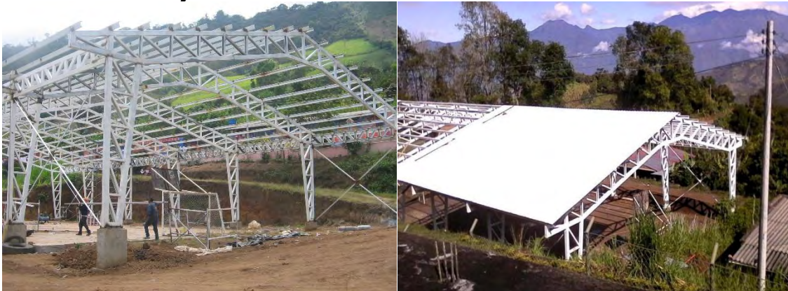
Fotografía 60. Instalación de correas metálicas, vigas riostras e instalación de cubierta en teja termoacústica.
