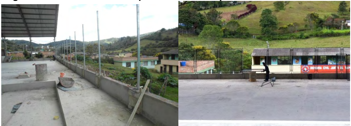
Fotografía 33. Instalación de tubo galvanizado 2" tipo pesado y marcos en ángulo con malla eslabonada para cerramiento perimetral.
