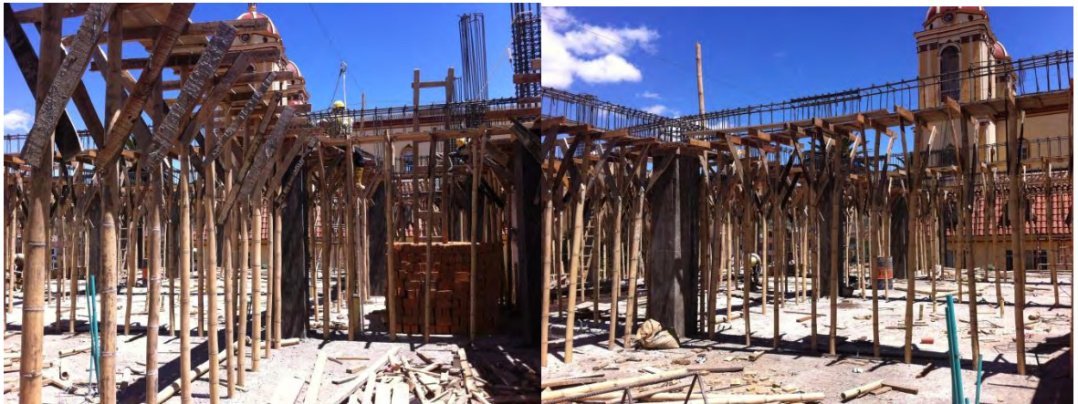
Fotografía 8. Corte y figurado de hierro, formateado de vigas aéreas en segundo nivel N+4.05 para posterior fundición
