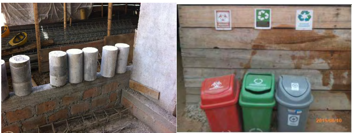
Fotografía 14. Toma de muestras de concreto de zapatas, vigas, columnas y losas para ensayos de resistencia sobre cilindros. Zona temporal de residuos sólidos
