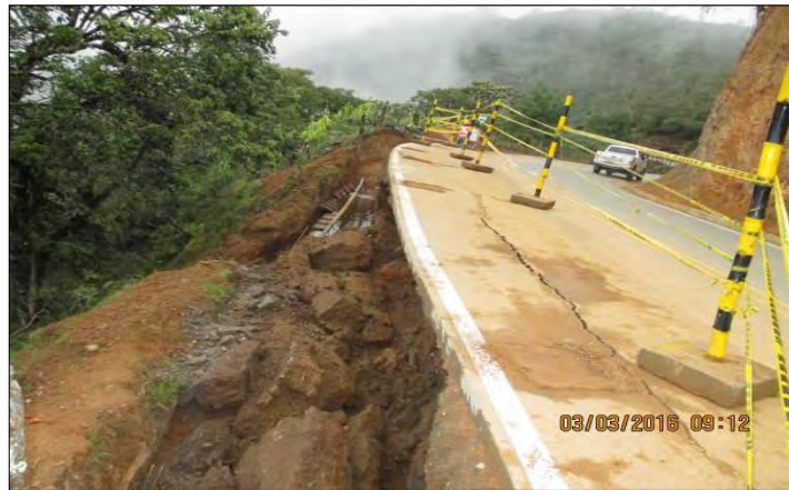
Ilustración 2. Pérdida de banca.
