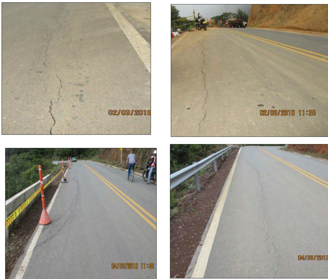
Ilustración 1. Fisuras pavimento existente.
