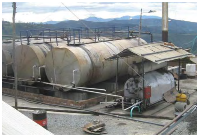
Figura 21. Tanques de almacenamiento de Asfalto.
