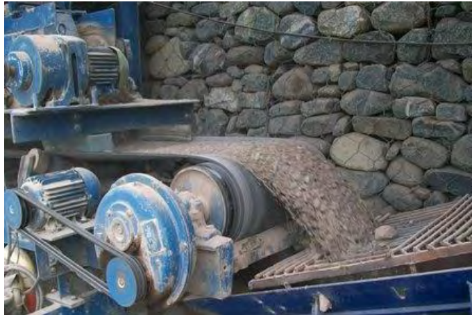
Figura 22. Banda recolectora de Agregado
