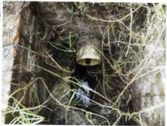
Cámara aguas negras con raíces
