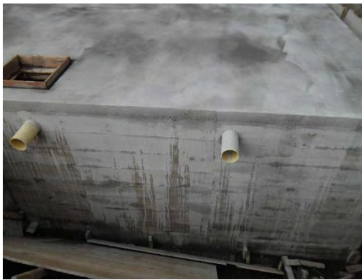
Imagen 1.22 Pase para tubería de llenado con agua lluvia.
