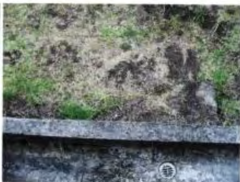
Cámara sellada cubierta zona verde
