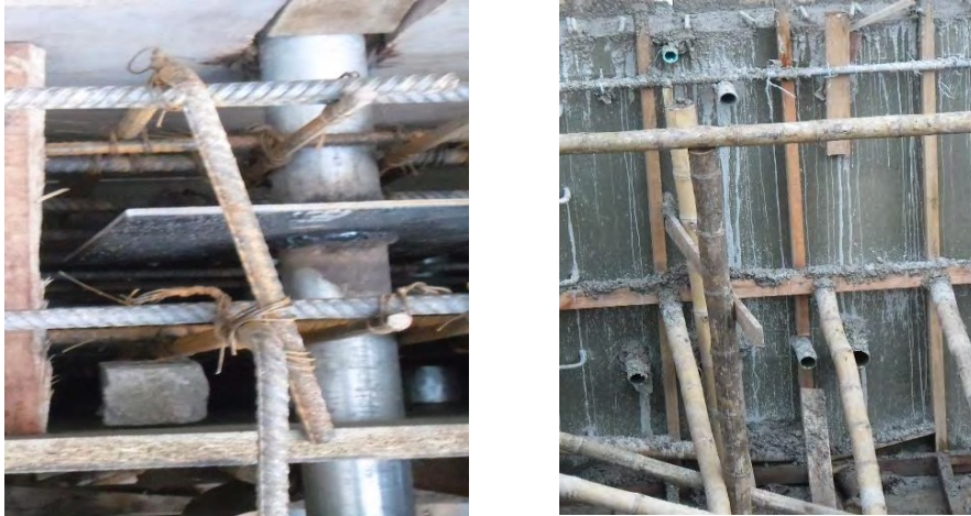
Imagen 1.21 Pase para tubería de llenado con agua potable.
