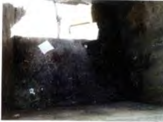
Cámara con raíces y escombros
