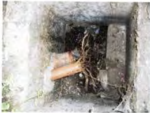
Cámara con raíces y colmatada
