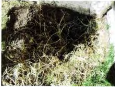
Cámara cubierta con raíces
