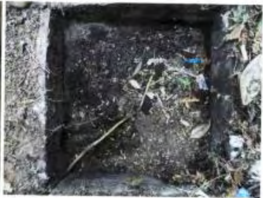
Cámara de aguas lluvias colmatada
