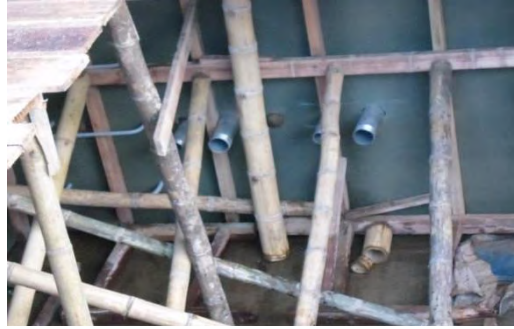
Imagen 1.23 Pases para tubería de succión.
