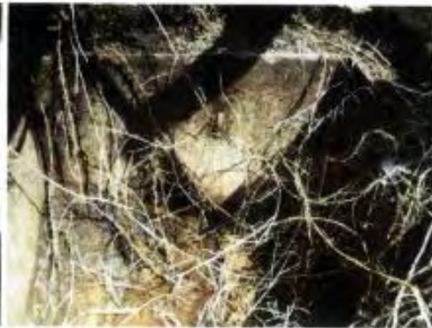
Cámara de aguas lluvias con raíces
