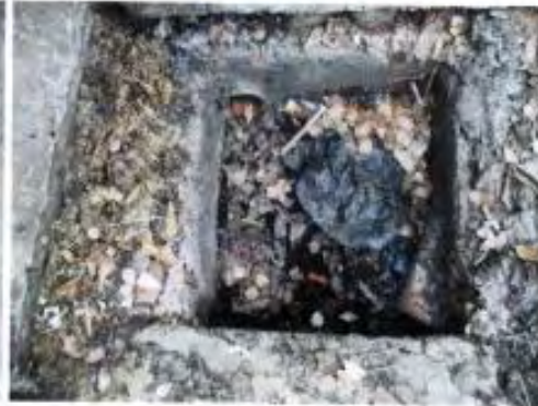
Cámara de aguas lluvias colmatada
