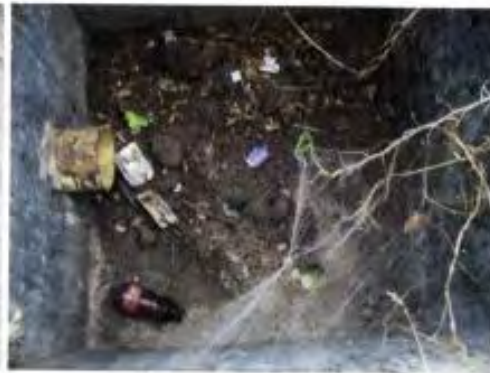
Cámara aguas lluvias con basura
