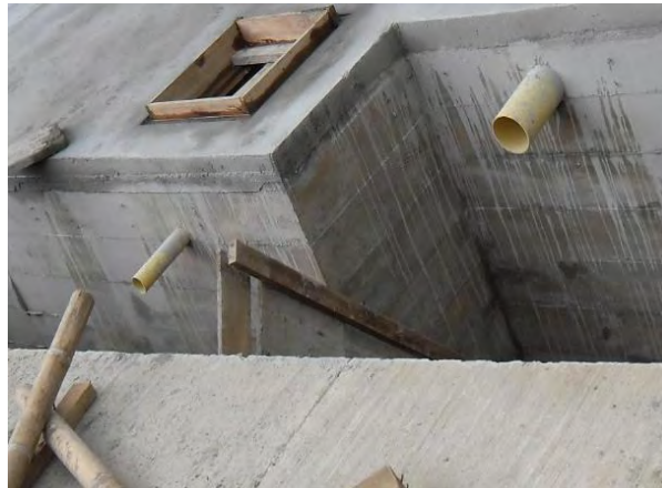
Imagen 1.20 Pase para tubería de rebose.
