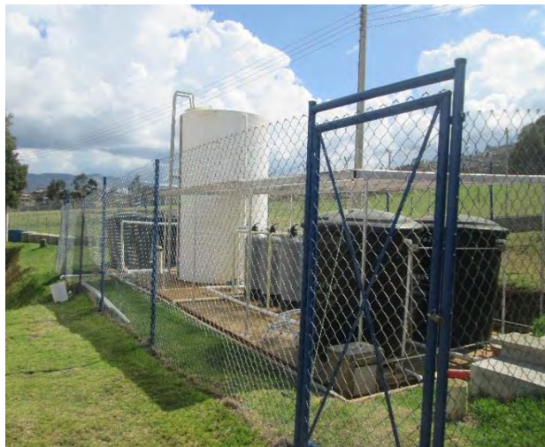
Fotografía 3.5. Filtros y tanques de almacenamiento.
