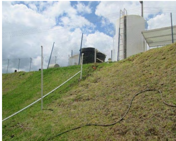
Fotografía 3.4. Tanque de almacenamiento
