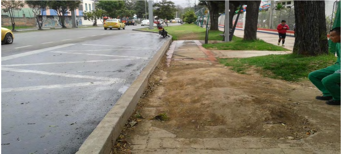
Ilustración 49. Estado del sitio a intervenir, por anterior intervención del equipo de redes de EMPOPASTO.
