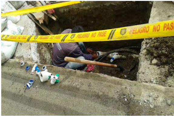
Ilustración 32. Conexiones domiciliarias y accesorios.
