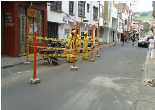
Ilustración 38. Colombinas y cinta de peligro.
