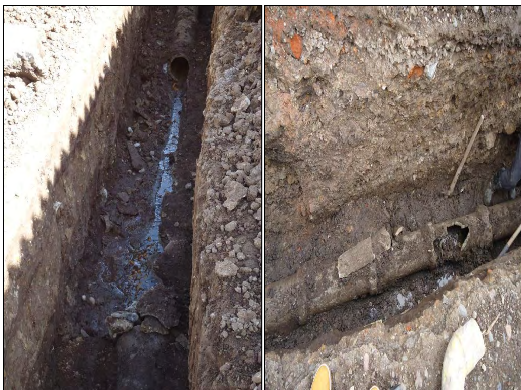
Figura 2. Estado de la tubería.
