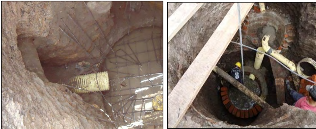
Figura 23. Aditamento de caída
