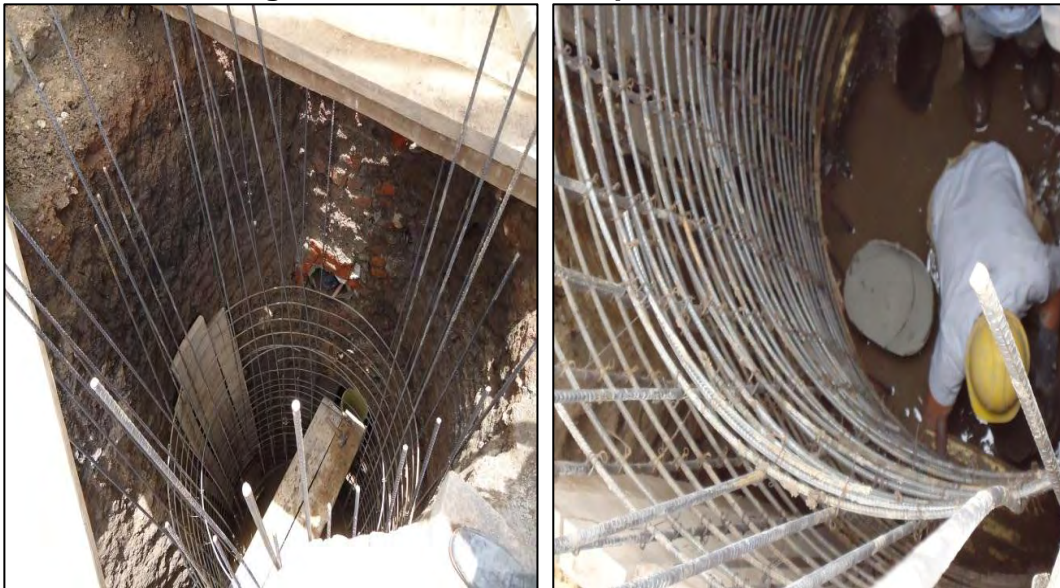
Figura 39. Cámara de inspección estructurada.
