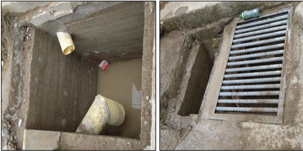
Figura 24. Sumidero en concreto
