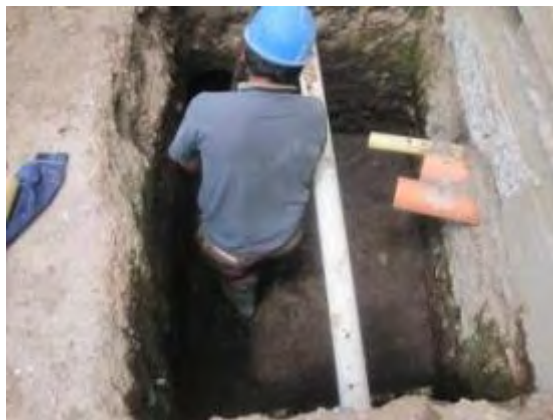
Figura 30. Cajas de inspección
