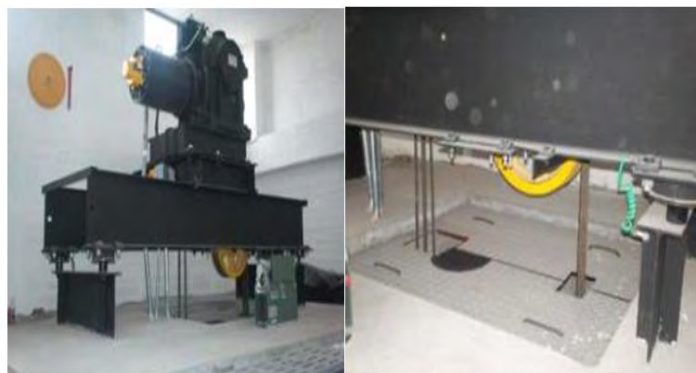
Figura 43. Máquinas que conforman el ascensor
