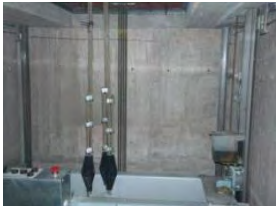
Figura 42. Cuarto de máquinas para el ascensor
