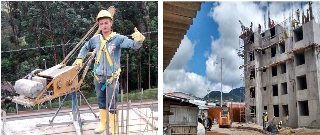
Figuras 67 y 68. Utilización de arnés, plataforma para apoyar la pluma, colocación de camillas con palomeras metálicas en los extremos de la edificación.
