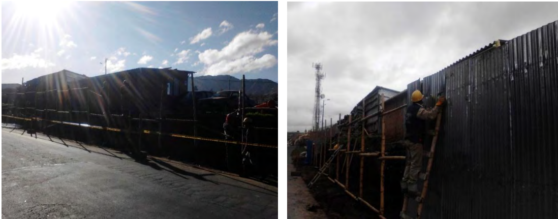
Figuras 4 y 5. Cerramiento inicial de la obra, desmonte y reubicación del cerramiento
