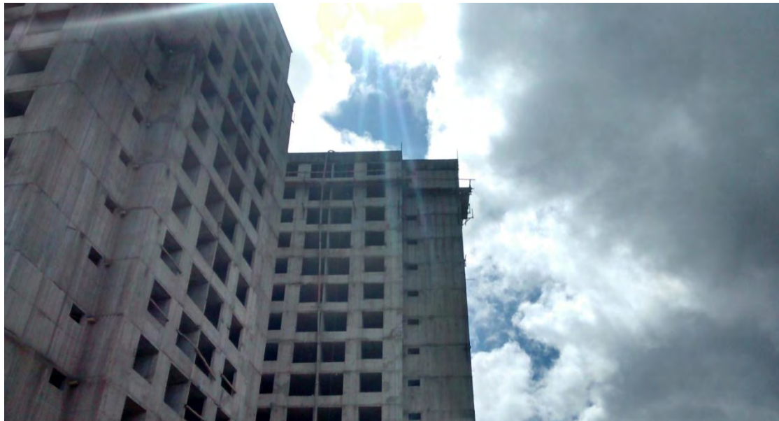
Figura 65. Estado completo de las torres después de la fundición de los apartamentos.
