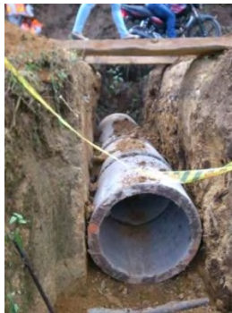
Figura 7. Tubería de concreto reforzado de 900mm.
