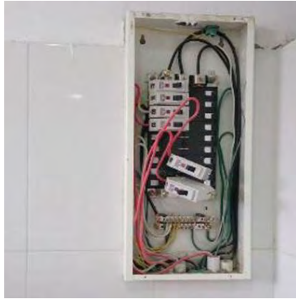
Figura 84. Tablero de 18 circuitos.
