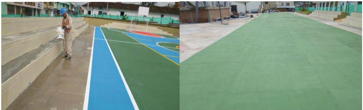
Figura 13. Pintura en graderías inferior derecha cancha multifuncional y cancha de chaza.
