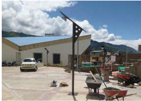
Figura 30. Luminaria led 50w poste 3m.
