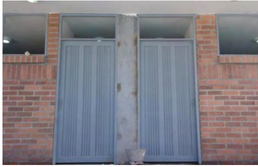
Figura 24. Puertas metálicas de 1,00 x 2,10 metros.
