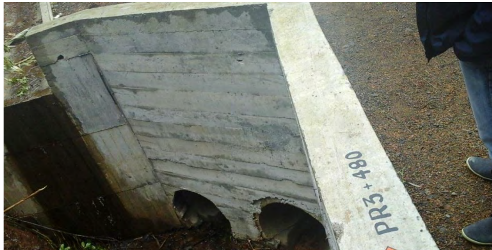
Figura 9. PR3+480 alcantarilla doble de 36".
