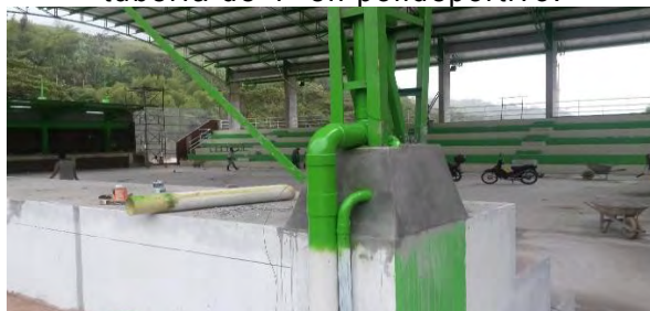
Imagen 87 Bajantes de aguas lluvias en tubería de 4" en polideportivo.
