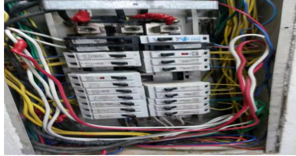
Imagen 91 Tablero de distribución de circuitos eléctricos.
