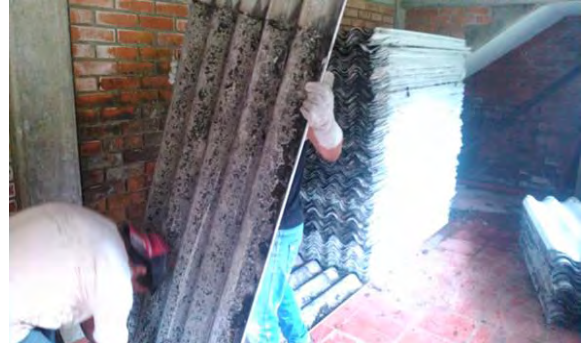
Imagen 13 Disposición final de tejas de asbesto cemento.
