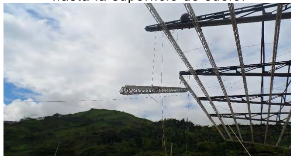
Imagen 17 Desprendimiento de correas hasta la superficie de suelo.
