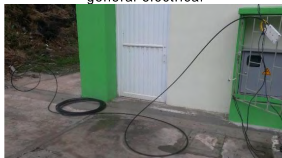
Imagen 89 Cableado de acometida general eléctrica.
