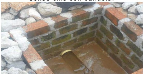
Imagen 82 Caja de inspección de 80x80 cms con cañuela.
