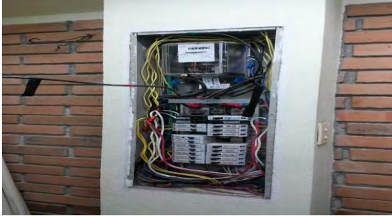
Imagen 90 Tablero de distribución de circuitos.
