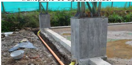
Imagen 84 Tubería de 3" para transporte de aguas lluvias.
