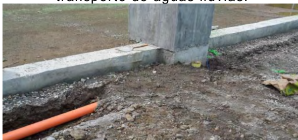
Imagen 85 Tubería sanitaria 3" para transporte de aguas lluvias.
