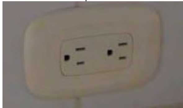
Imagen 93 Toma corriente doble con sistema de puesta a tierra.
