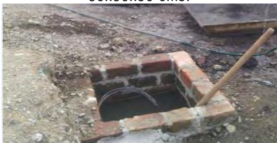
Imagen 80 Caja de inspección de 60x60x60 cms.
