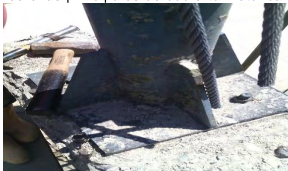
Imagen 21 Cables tensores cortados de cerchas principales de cubierta metálica.
