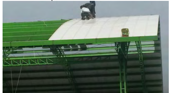
Imagen 111 Instalación de teja sin traslapo en cancha sintética.
