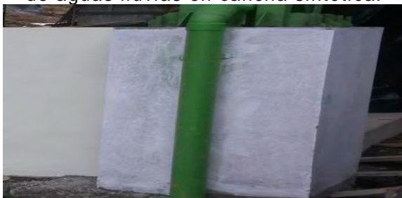
Imagen 86 Tubería de 3" para bajantes de aguas lluvias en cancha sintética.
