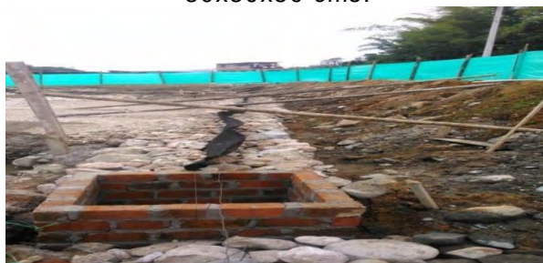
Imagen 83 Caja de inspección de 80x80x80 cms.
