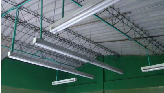
Ilustración 49. Estado de la cubierta en el morgue.
