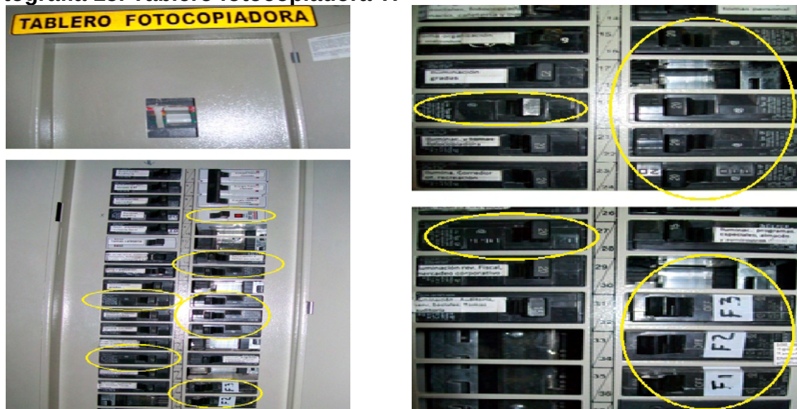
Fotografía 15. Tablero fotocopidora TF
