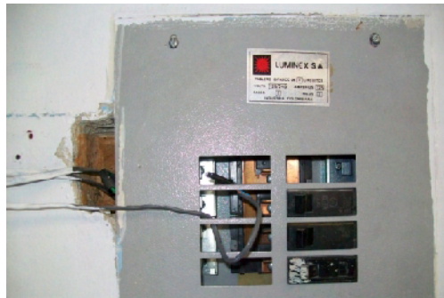
Fotografía 14. Tablero MAC TM
