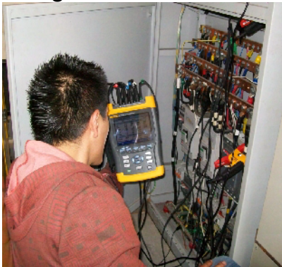
Fotografía 1. Medición con Fluke 434
