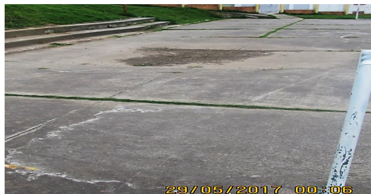
Imagen 10. Hundimiento de placa de concreto en polideportivo barrió Villa Lucia C19 Cr21a.
