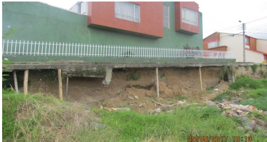
Imagen 11. Desplome de base estructural por subsidencia barrió Villa Lucia CI 5.
