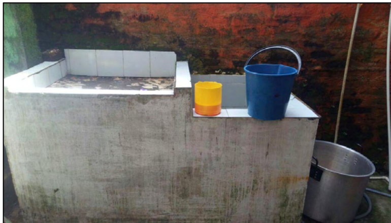
Imagen 10. Tanque de almacenamiento de agua, CDI Panamá 1.
