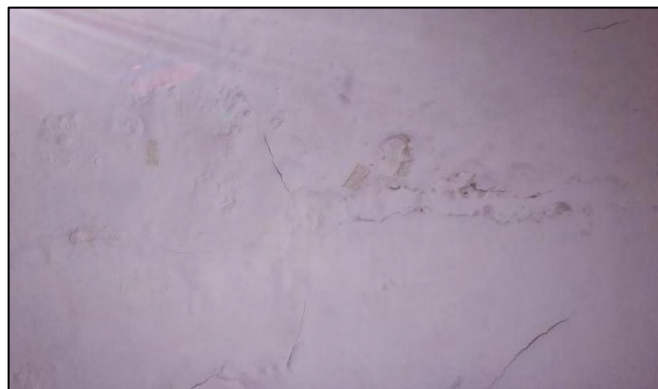
Imagen 4. Manchas en las paredes, producto de aparentes filtraciones de agua.
