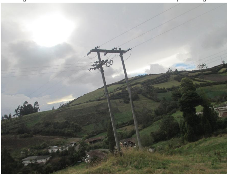
Imagen 5: Infraestructura eléctrica sección Los Ajos Tangua
