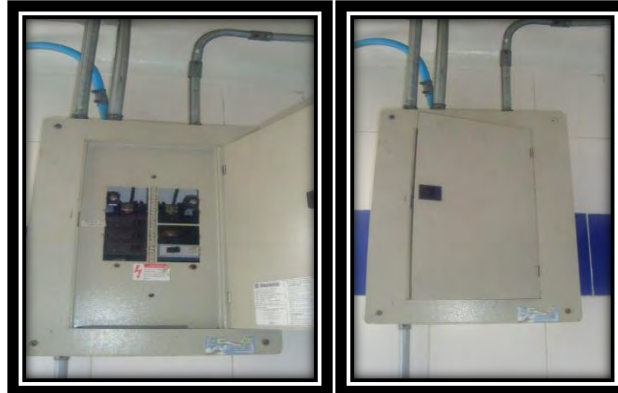
FIGURA 2.60. Colacteos Guachucal, tablero de breakers portería.
