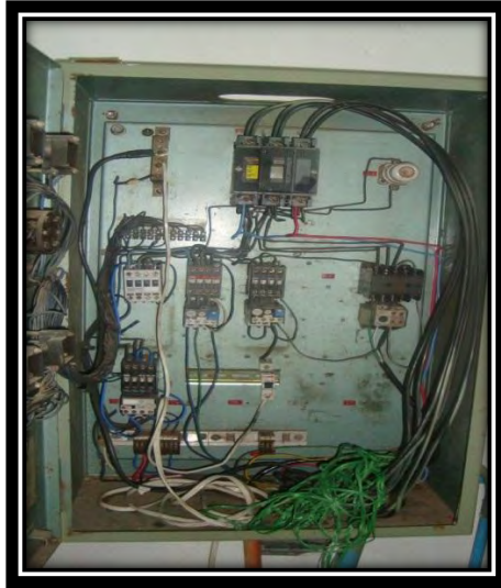
FIGURA 2.16. Colacteos Guachucal, tablero hidroneumático 2 a 220v
