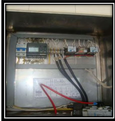
FIGURA 2.35. Colacteos Guachucal, tablero control recepción de leche.
