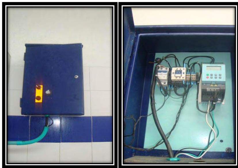
FIGURA 2.27. Colacteos Guachucal, tablero de equipos de presión positiva.
