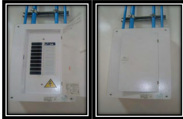
FIGURA 2.58. Colacteos Guachucal, tablero de breakers cava parmesano 1.
