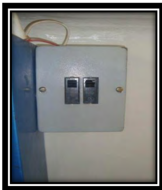
FIGURA 2.45. Colacteos Guachucal, tablero de breakers a lado tablero compresor.
