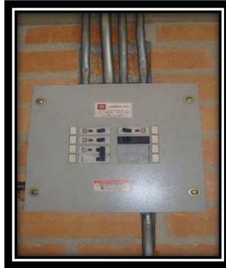
FIGURA 2.54. Colacteos Guachucal, tablero de breakers cocina
