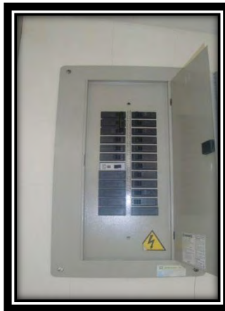
FIGURA 2.29. Colacteos Guachucal, tablero de breakers primer piso.
