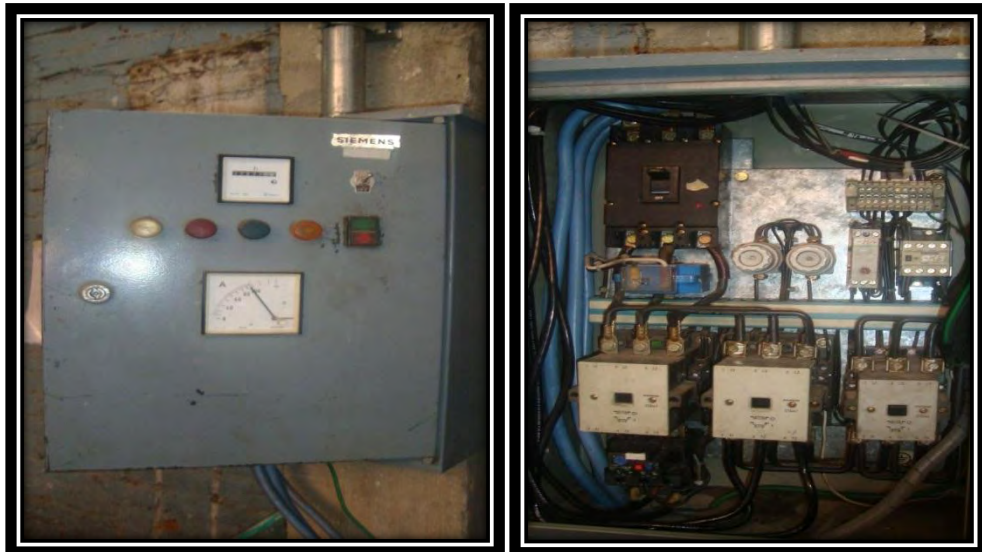
FIGURA 2.19. Colacteos Guachucal, tablero cuarto de máquinas 2.
