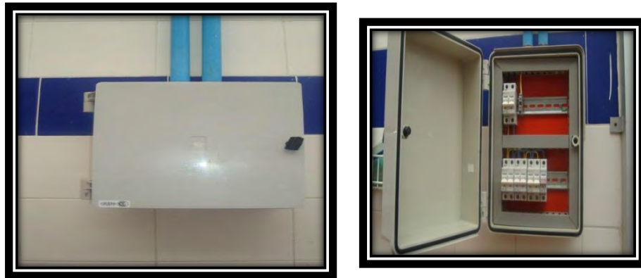
FIGURA 2.38. Colacteos Guachucal, tablero pasillo 1.
