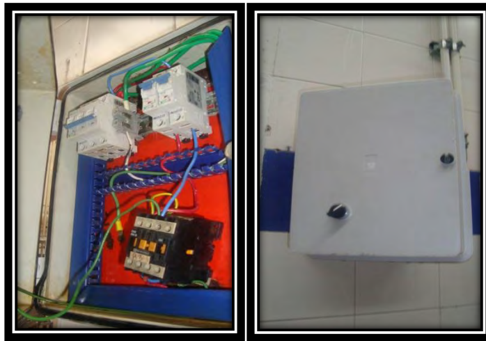
FIGURA 2.47. Colacteos Guachucal, tablero de disyuntores quesera 2.
