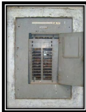
FIGURA 2.24. Colacteos Guachucal, tablero de Breakers 2.
