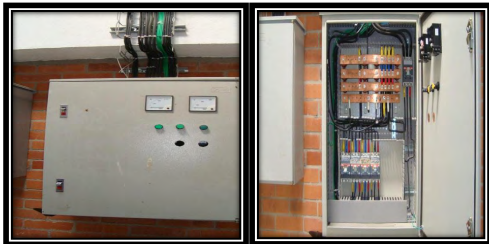
FIGURA 2.6. Colacteos Guachucal, tablero de distribución de 30kva.
