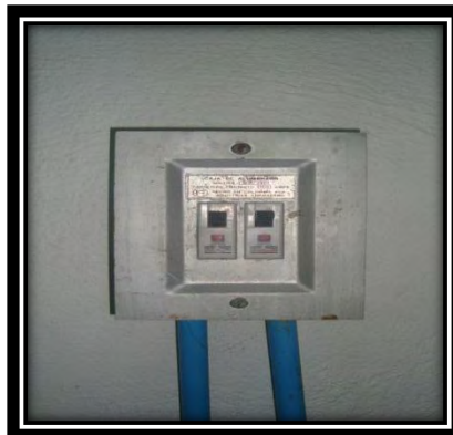
FIGURA 2.17. Colacteos Guachucal, tablero de breakers.
