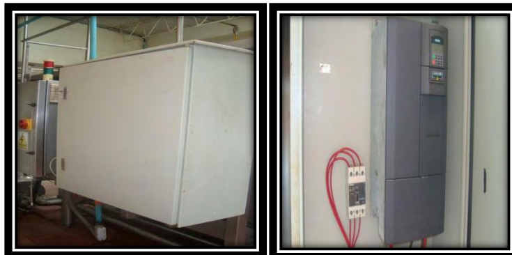
FIGURA 2.32. Colacteos Guachucal, tablero segundo piso zona CIP.
