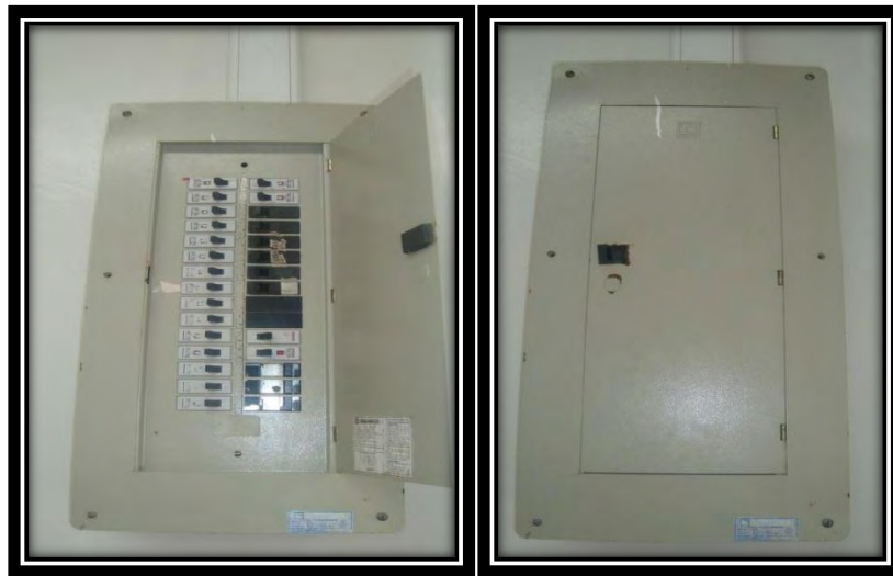
FIGURA 2.49. Colacteos Guachucal, tablero de breakers maduración.
