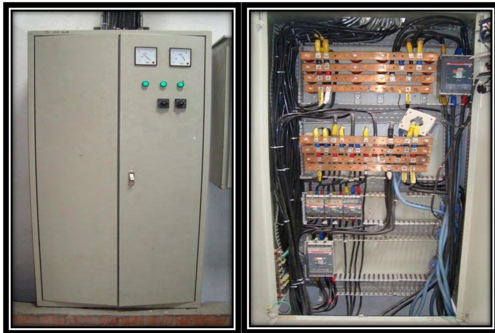
FIGURA 2.2. Colacteos Guachucal, tablero de distribución de 150KVA.
