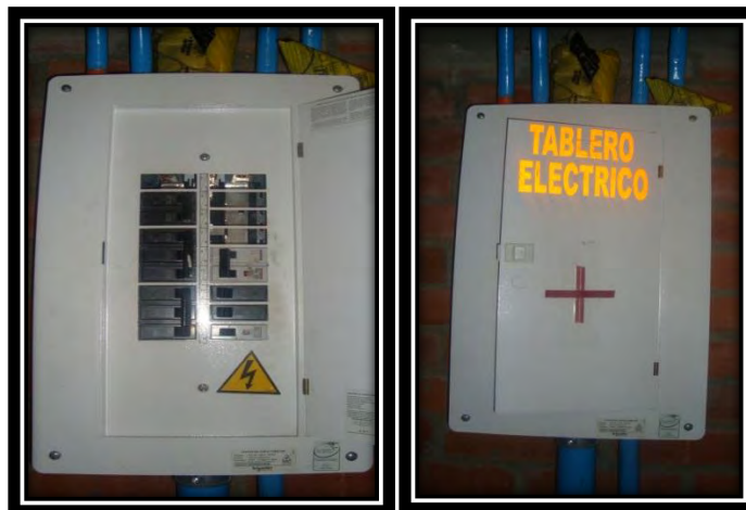
FIGURA 2.52. Colacteos Guachucal, tablero de breakers mantenimiento.
