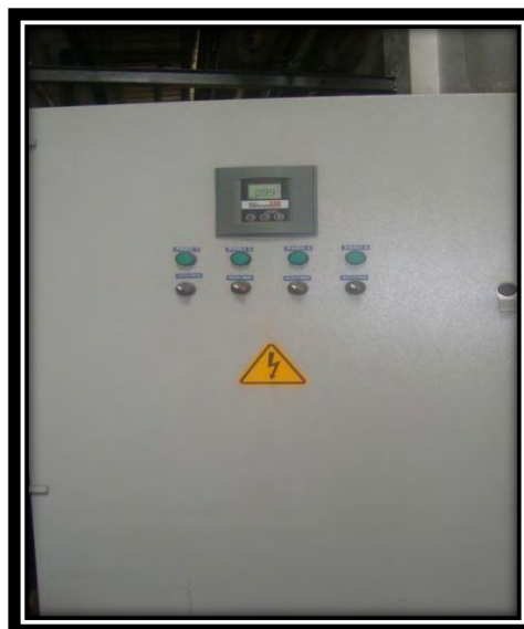
FIGURA 2.10. Colacteos Guachucal, tablero de condensadores a 440v.
