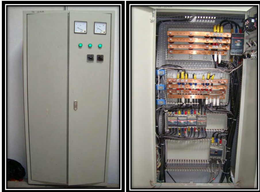
FIGURA 2.4. Colacteos Guachucal, tablero de distribución de 112kva.
