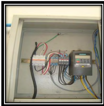
FIGURA 2.44. Colacteos Guachucal, tablero segundo piso quesera.
