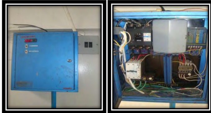
FIGURA 2.45. Colacteos Guachucal, tablero azul compresor y difusor.
