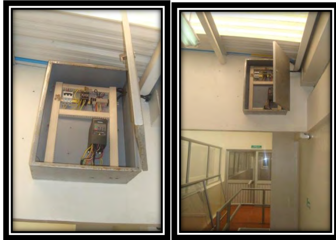
FIGURA 2.46. Colacteos Guachucal, tablero subida escaleras bodega segundo piso.
