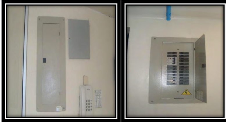
FIGURA 2.31. Colacteos Guachucal, tablero de breakers laboratorio calidad segundo piso.
