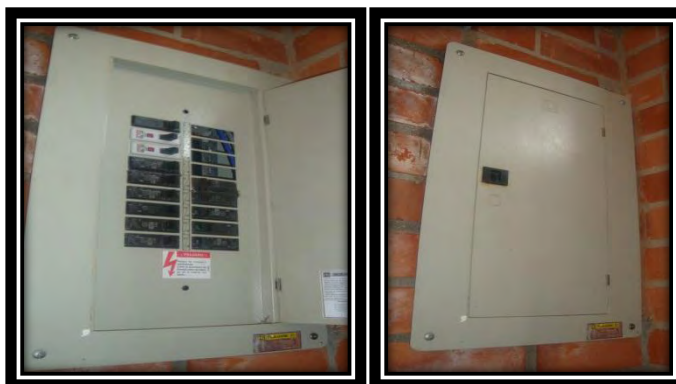
FIGURA 2.63. Colacteos Guachuca, tablero de breakers oficinas 2.
