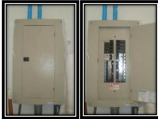
FIGURA 2.53. Colacteos Guachucal, tablero de breakers almacén.
