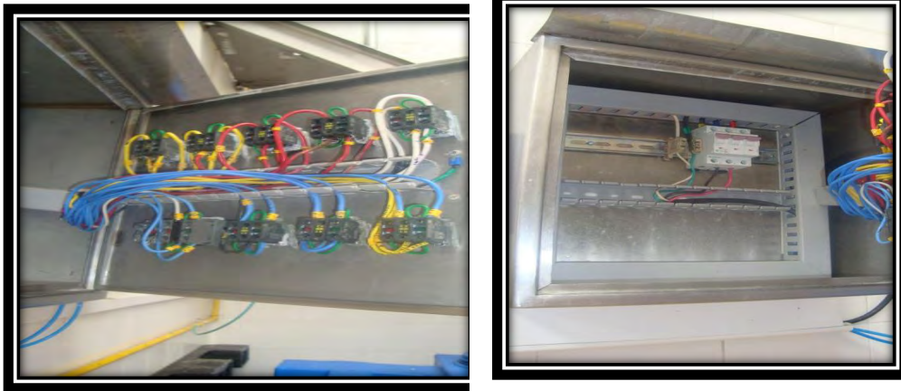
FIGURA 2.32. Colacteos Guachucal, tablero de control de tanques.
