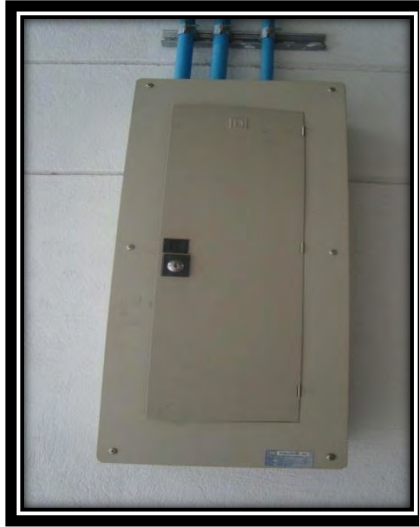
FIGURA 2.13. Colacteos Guachucal, tablero de breakers.
