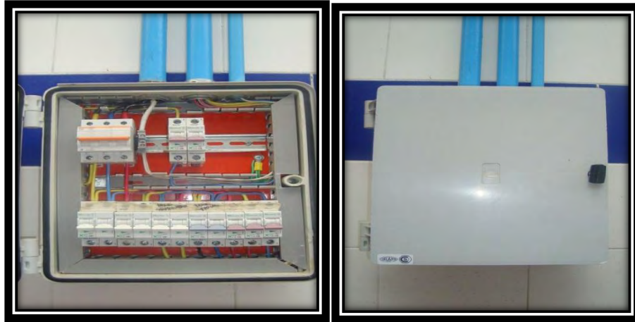
FIGURA 2.39. Colacteos Guachucal, tablero pasillo 2.
