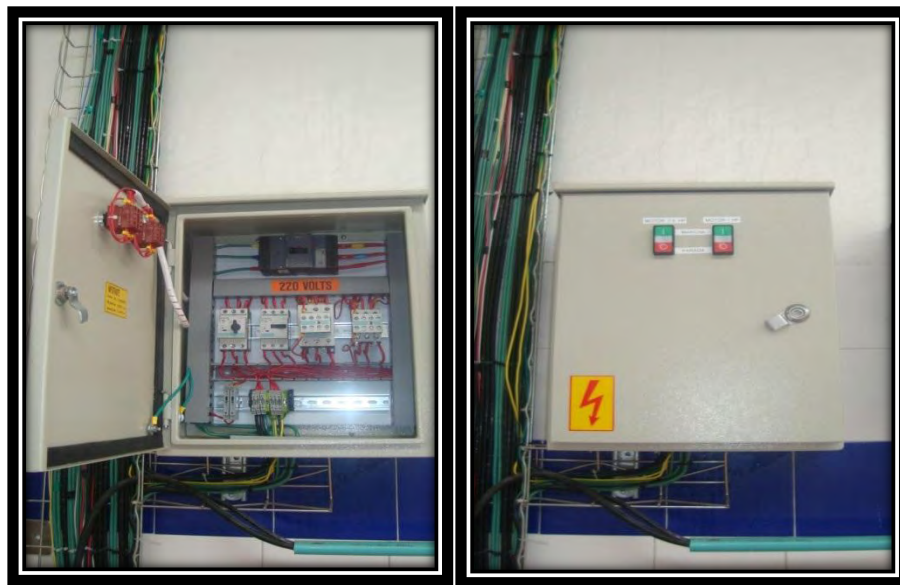
FIGURA 2.26. Colasteos Guachucal, tablero de control de motores de 7.5 y 1 hp
