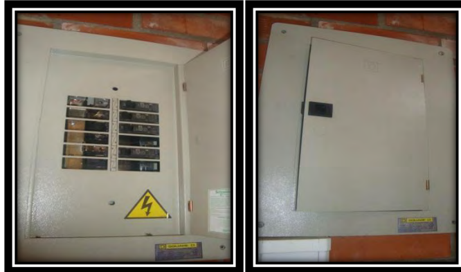
FIGURA 2.62. Colacteos Guachucal, tablero de breakers oficina 1.
