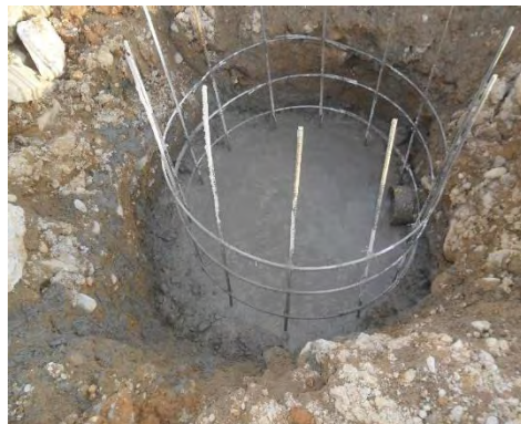
Ilustración 17. Acero de cámara de inspección
