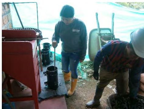
Ilustración 38. Apisonamiento de 1° capa en cilindro para ensayo de resistencia a la compresión.
