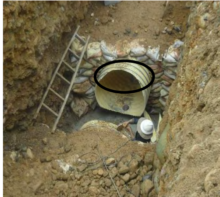
Ilustración 10. Corte semicircular de tubería
