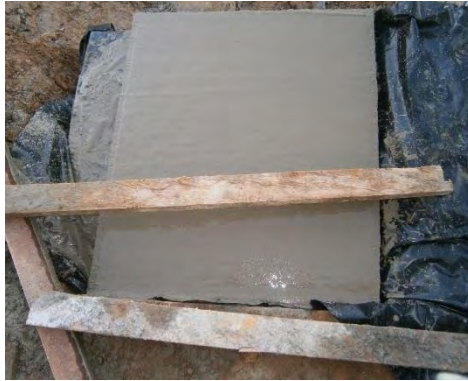
Ilustración 20. Cajilla de inspección
