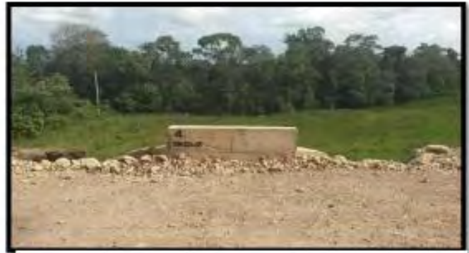
Ilustración 67. Alcantarilla de decole N°4
