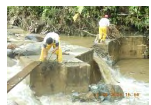
Figura 29. Estructura afectada por la ola invernal
