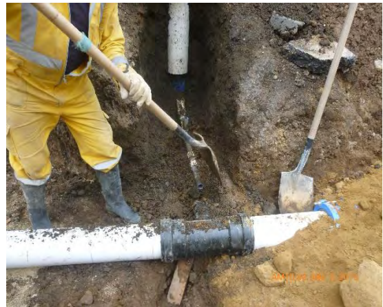
Foto 40. Acometida domiciliaria acueducto
