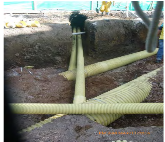
Foto 34. Tuberías domiciliarias alcantarillado
