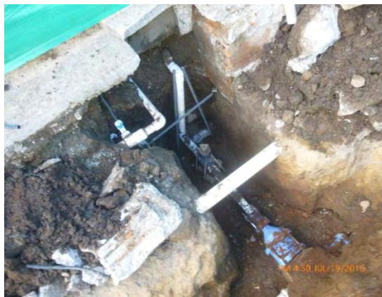
Foto 41. Acometida domiciliaria acueducto 2"
