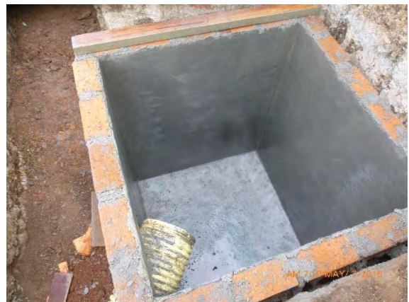
Foto 76. Cajilla domiciliaria de alcantarillado
