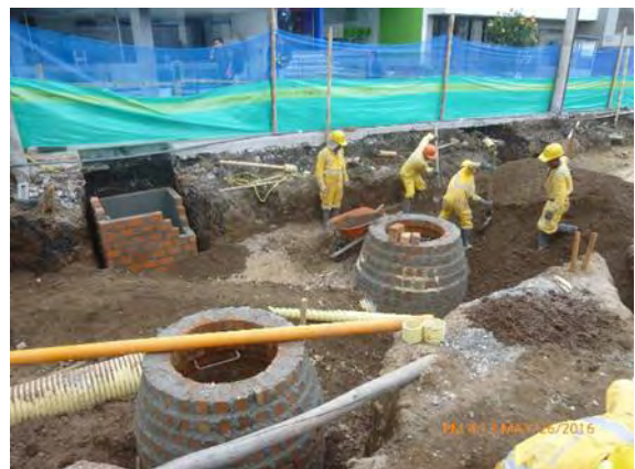
Foto 74. Pozo de inspección cónico
