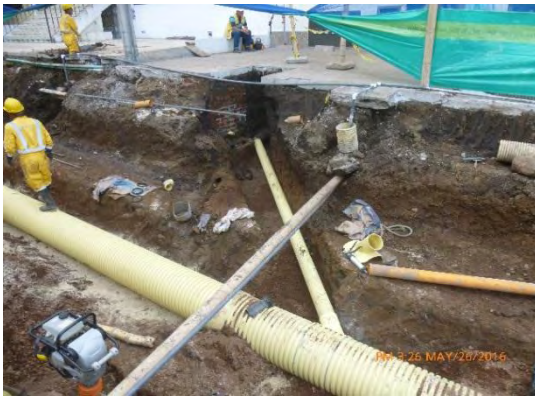
Foto 16. Suministro provisional de agua potable.
