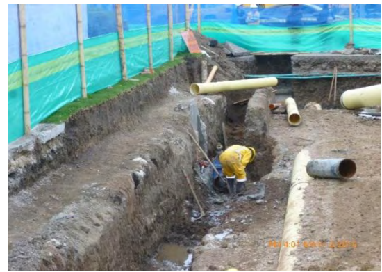
Foto 17. Corte suministro agua EMPOPASTO
