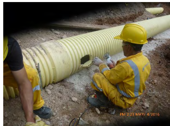
Foto 43. Perforación de tubería colector
