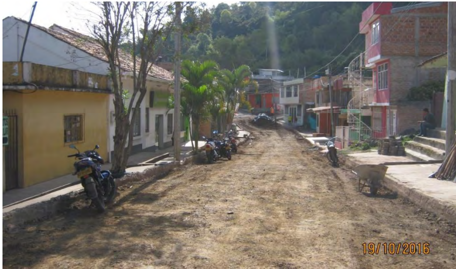
Ilustración 40. Estado actual de las vías.
