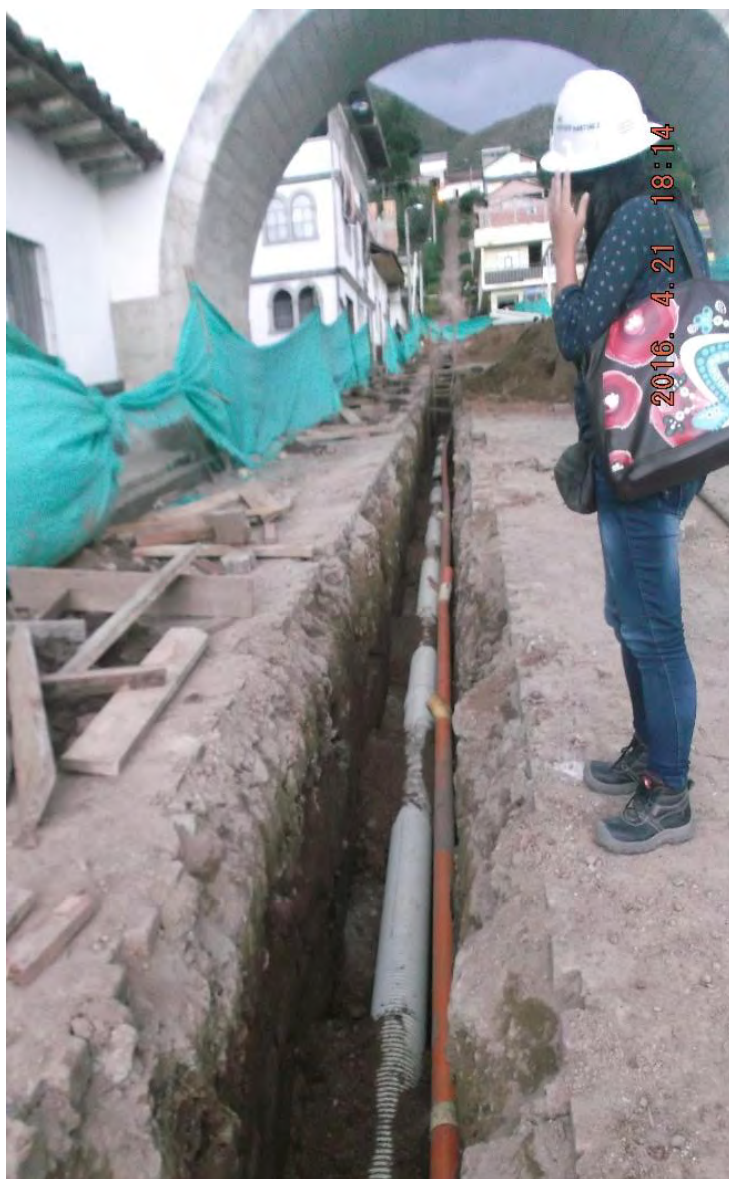
Ilustración 20. Tubería auxiliar paralela.
