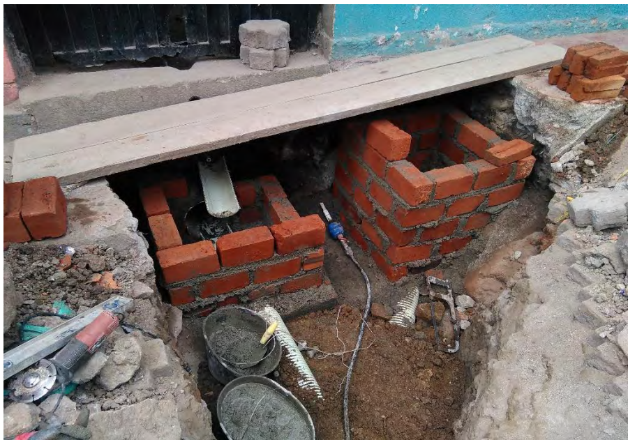
Ilustración 25. Cajillas de inspección.
