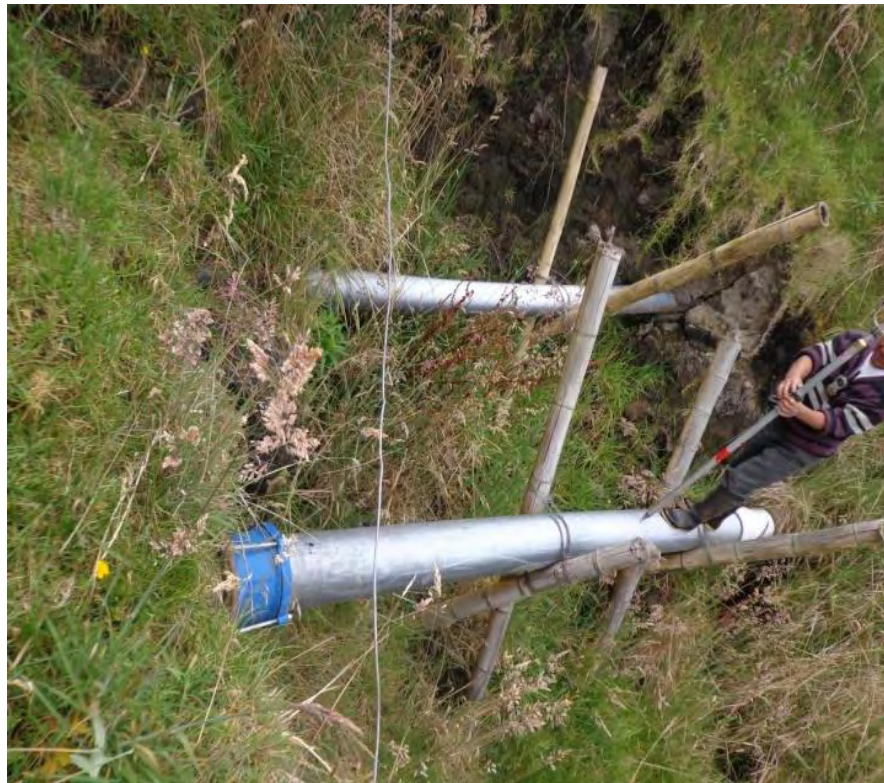
Ilustración 46. Tubería a ser cambiada.
