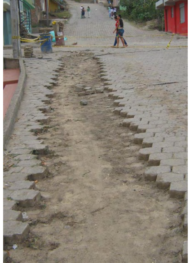
Ilustración 42. Estado actual de las vías.
