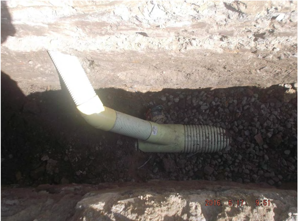
Ilustración 23. Tubería 6' acometida domiciliaria.
