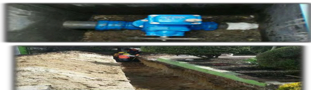
Ilustración 44. Válvula ventosa y excavación a la entrada a planta de tratamiento
