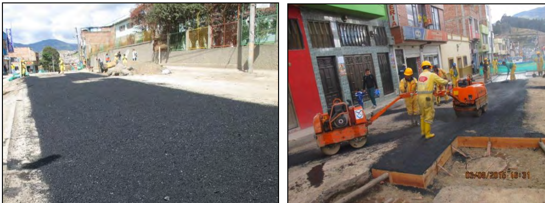
Figura 61. Parcheo de pavimento asfáltico.
