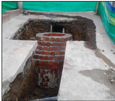
Figura 50. Aliviadero en bocacalle.
