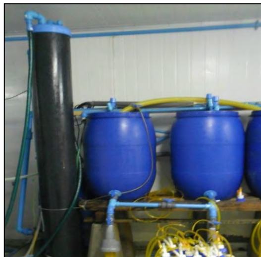
Figura 4. Sistema de inyección de nitrógeno gaseoso.
