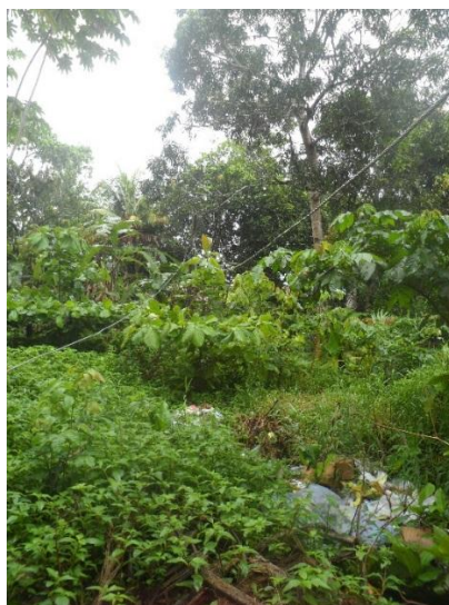
Figura 5. Tramo de red caída vereda El Naranjo.
