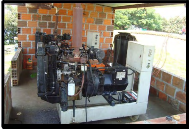
Figura 14. Zona de plantas eléctricas
