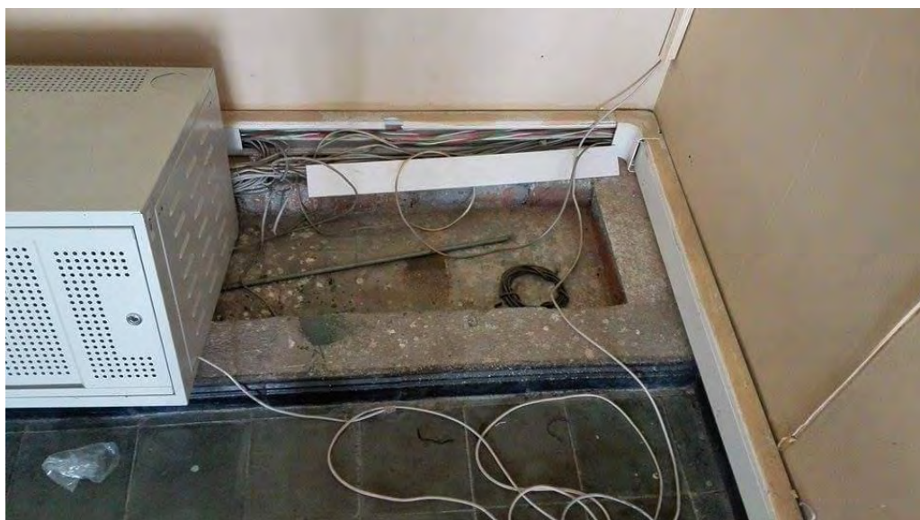
Figura 8: Evidencia cableado de red y canaletas
