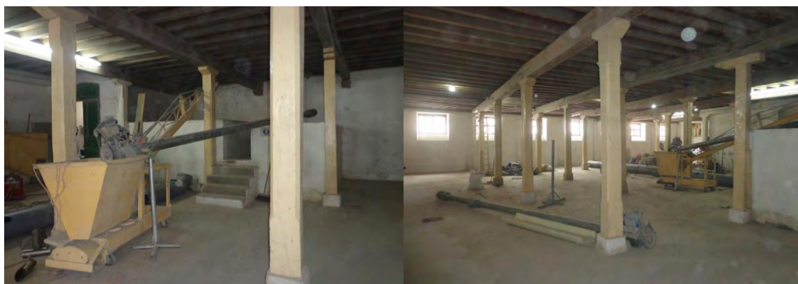
Figura 9. Bodega con presencia de moho
