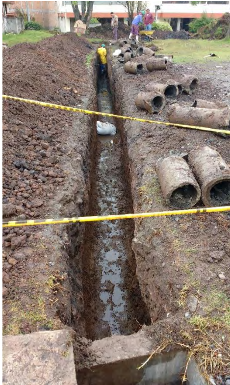
Imagen 24. Mejora de aguas residuales
