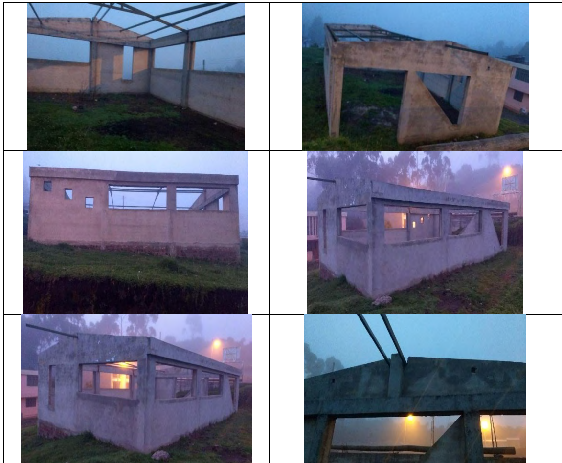
Imagen 35. Ejecución proyecto construcción de la primera etapa salón cultural múltiple urbanización villa floresta del municipio de Tuquerres
