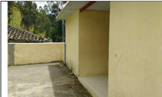
Imagen 1. Grietas en piso y muro por asentamiento de la estructura.
