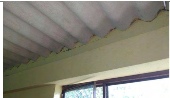
Imagen 2. Grietas en cubierta.
