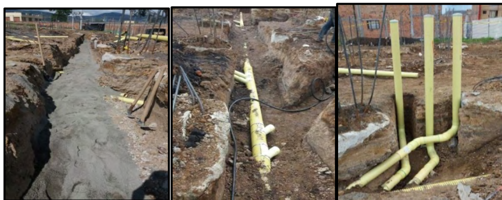
Figura 20. Instalación de colchón de arena, conexión de sillas yee y relleno. Diciembre de 2016.
