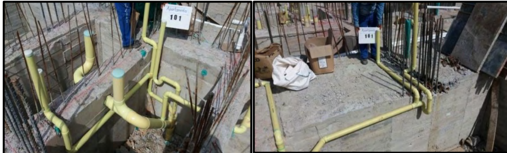
Figura 31. Instalaciones sanitarias del apartamento 101. Enero 2017.
