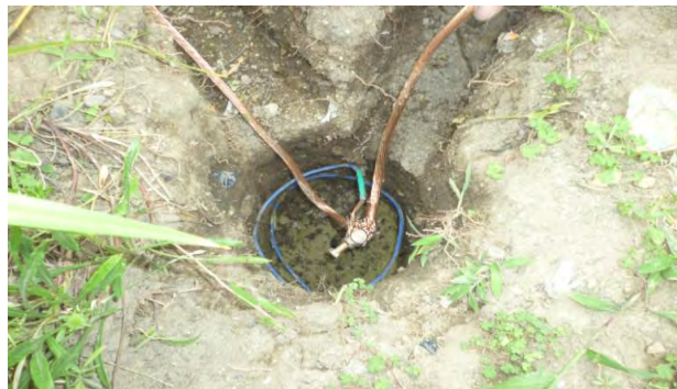
Figura 18. Sistema de puesta a tierra
