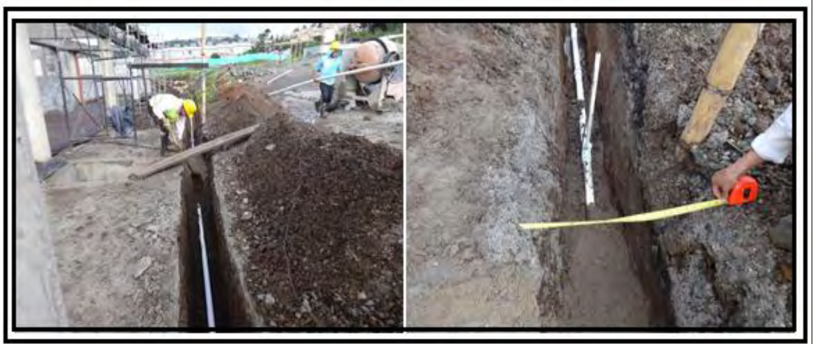
Figura 37. Tubería hidráulica de 3/4"
