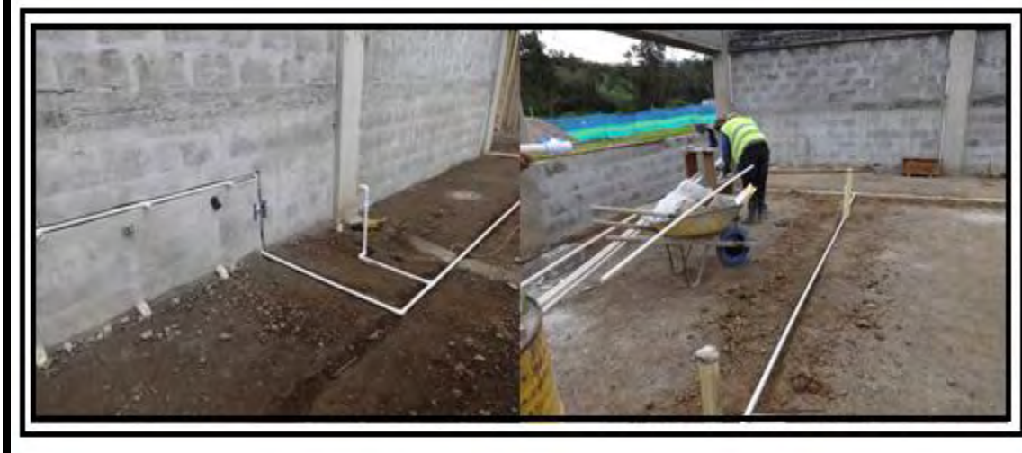
Figura 36. Tubería hidráulica de 3/4"
