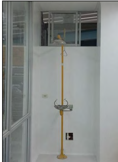
Figura 5. Instalación de ducha de emergencia- Anfiteatro.
