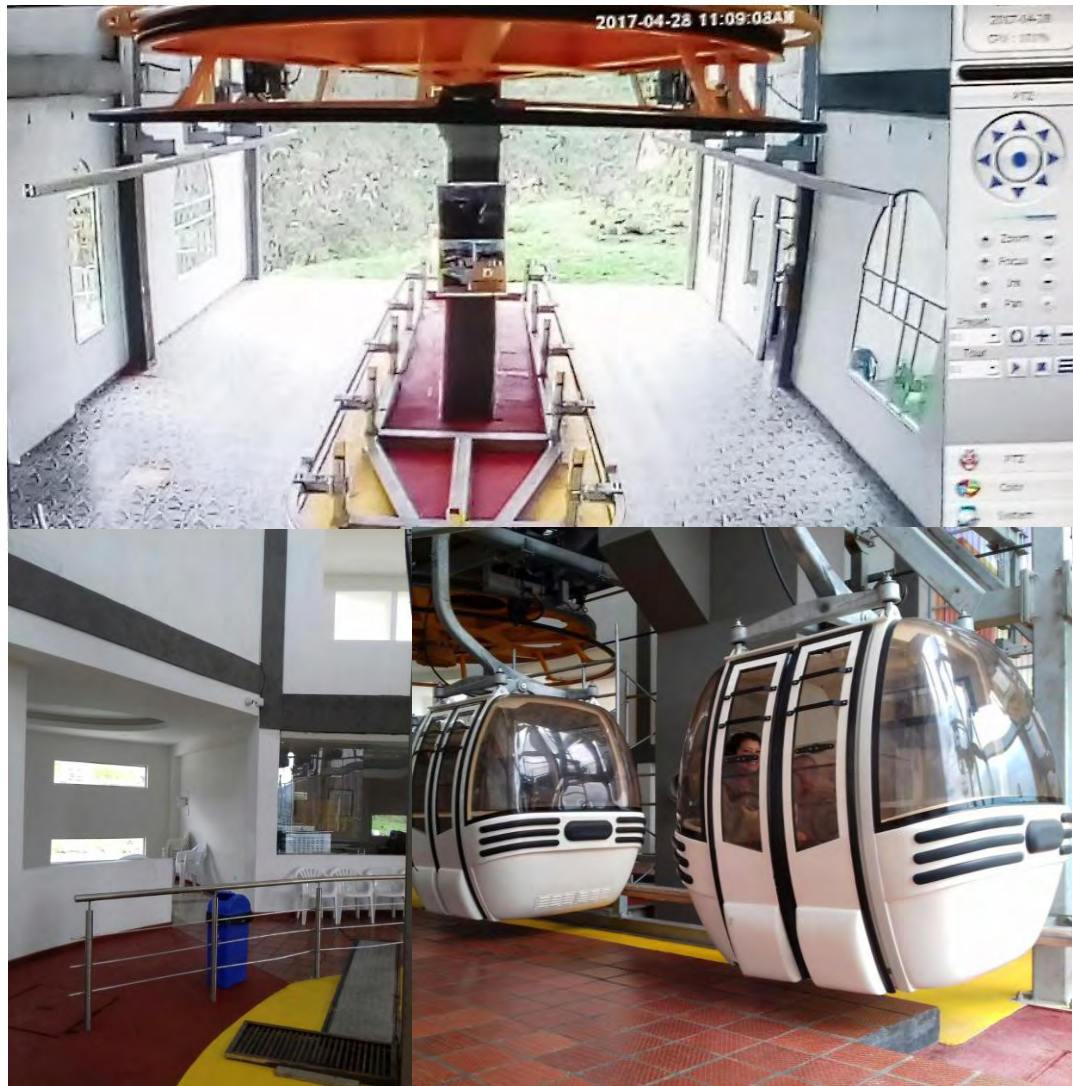
Figura 50. Estación salida zona de abordaje.
