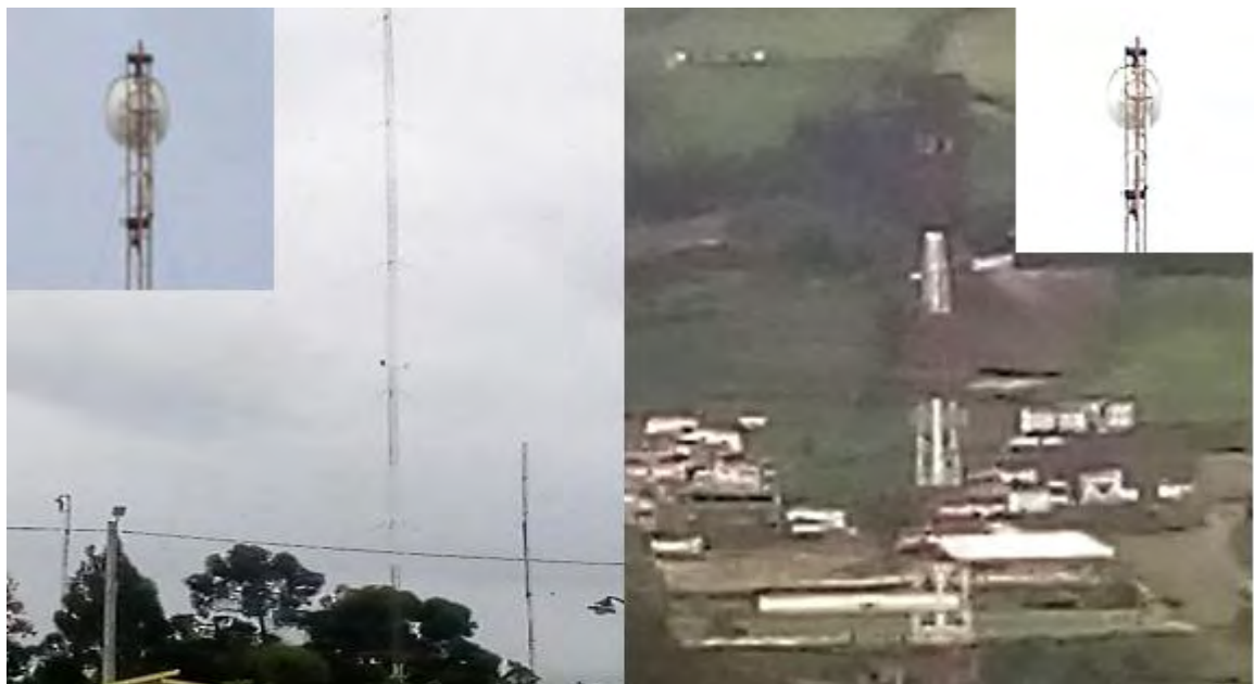
Figura 27. Enlace antena RCN Torre parqueadero
