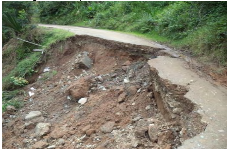
Imagen 3. Desplazamiento de masa en la vía.
