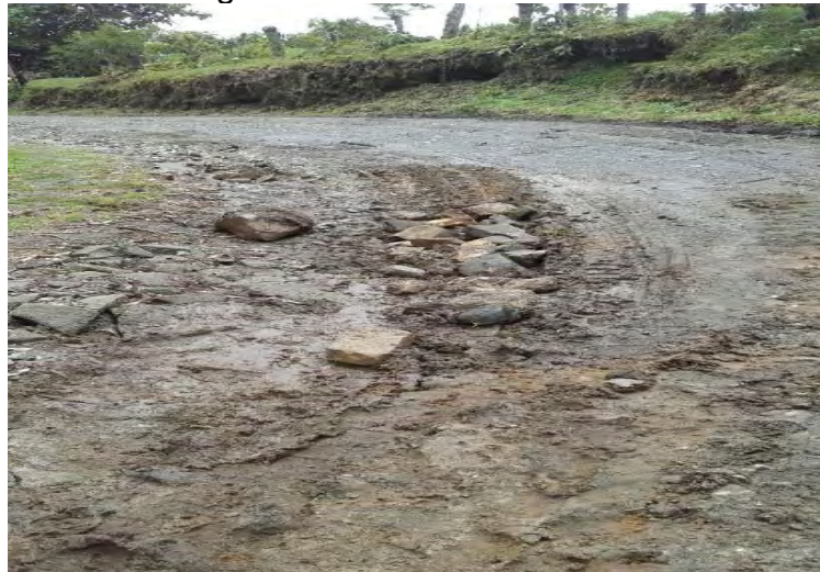
Imagen 148. Estado de carretera.
