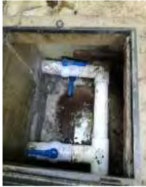
Imagen N°.79 Accesorios de tanque de almacenamiento.
