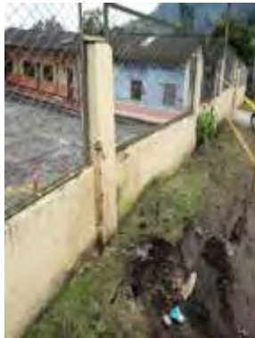
Imagen N°.99 Atención a solicitud presentada por comunidad por estructura en mal estado.
