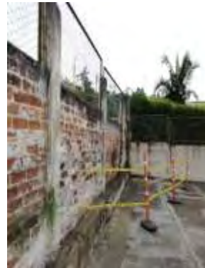
Imagen N°.100 Atención a solicitud presentada por comunidad por estructura en mal estado.
