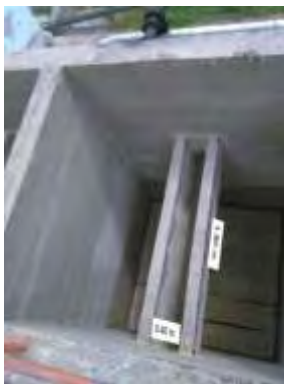
Imagen N°.1 Tanque de filtración
