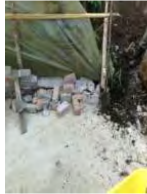
Imagen N°.96 Atención a solicitud de visita por deslizamiento de tierra que afecto vivienda familiar
