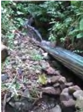
Imagen N°.21 Conducción inicial de aguas a bocatoma
