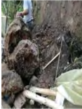
Imagen N°.95 Atención a solicitud de visita por deslizamiento de tierra que afecto vivienda familiar
