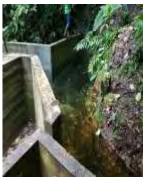
Imagen N°.75 Bocatoma de acueducto.
