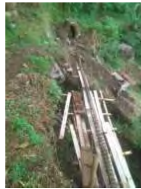
Imagen N°.34 Pozo de Inspección a conectar.
