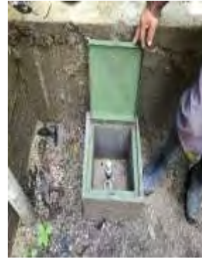
Imagen N°.80 Válvulas ventosas y sus respectivas cajillas.
