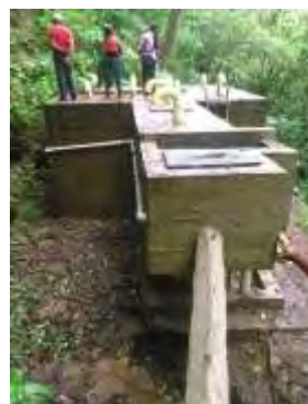
Imagen N°.78 Desarenador y tanque de almacenamiento.
