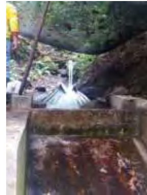
Imagen N°.22 Conducción inicial de aguas a bocatoma
