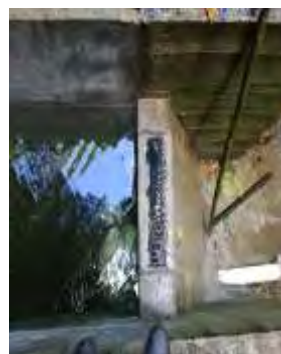
Imagen N°.76 Rejilla de estructura de captación.
