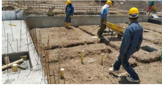
Figura 8. Instalaciones eléctricas, hidráulicas y sanitarias.
