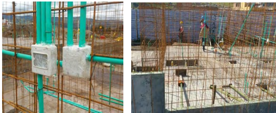
Figura 14. Instalaciones eléctricas, hidráulicas y sanitarias.
