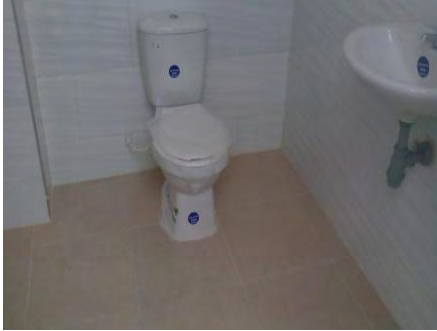
Foto 110. Cerámica antideslizante baños.
