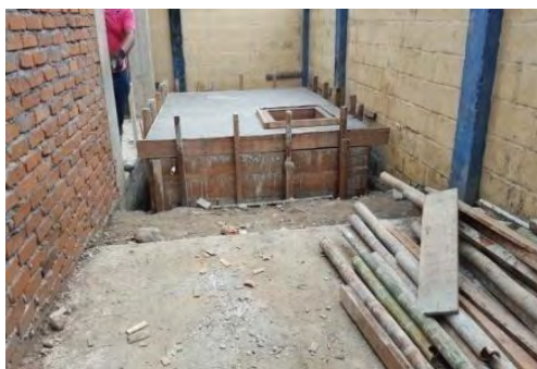
Foto 59: Tanque de almacenamiento.
