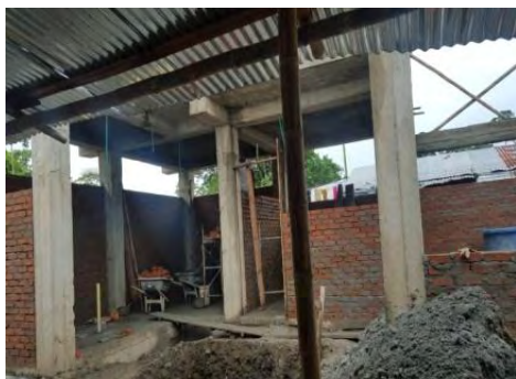
Foto 62. Mampostería batería sanitaria.
