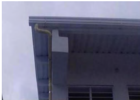
Foto 71. Canal en lámina galvanizada
