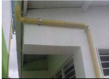
Foto 72. Bajante en tubería PVC de 3".
