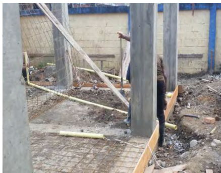
Foto 89. Tubería sanitaria de 2".
