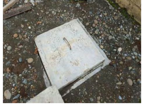
Foto 94. Tapa caja de inspección.
