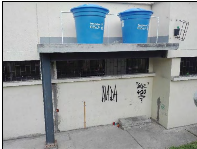
Figura 18. Perfil IPE, losa y tanques de abastecimiento de agua 500 lt.
