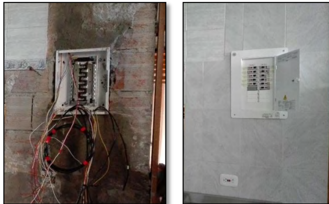
Figura 15. Acometida eléctrica para tablero trifásico de 18 circuitos
