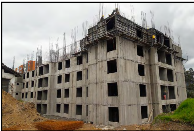
Figura 33. Estado final torre VI al terminar el periodo de pasantía en la obra.
