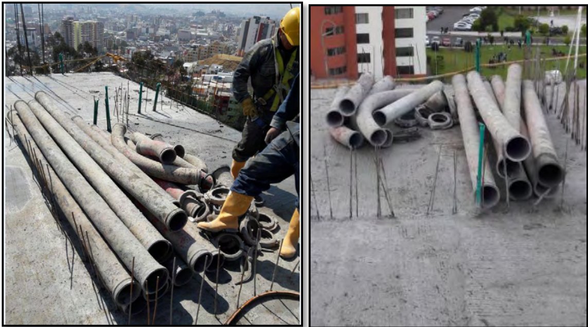
Figura 11. Ubicación correcta de tubería en un lugar adecuado.
