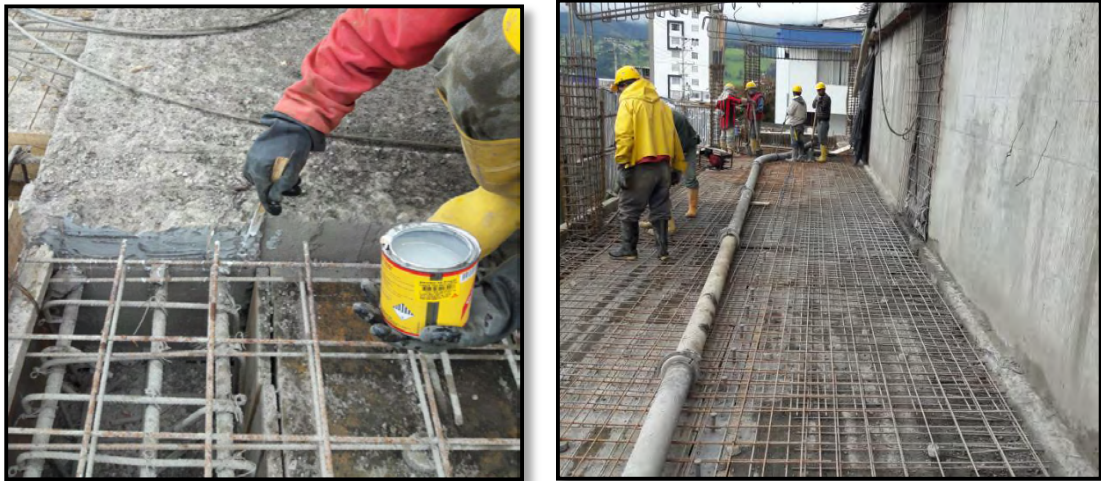
Figura 39. Aplicación de Sikadur 32 primer y fundición de continuación de losa de entrepiso número 1.
