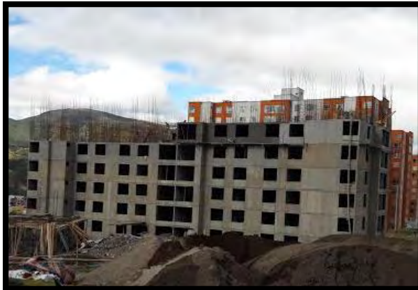
Figura 1. Estado inicial torre V al iniciar la pasantía en la obra Torres de Mariluz
