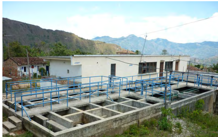
IMAGEN 34. Planta de tratamiento cabecera municipal.
