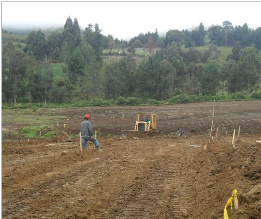
Figura 4 - Verificación de niveles
