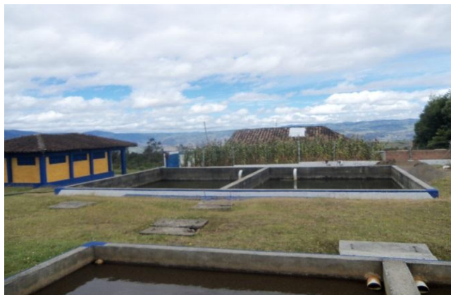
Fotografía 16. Unidad de filtración lenta
