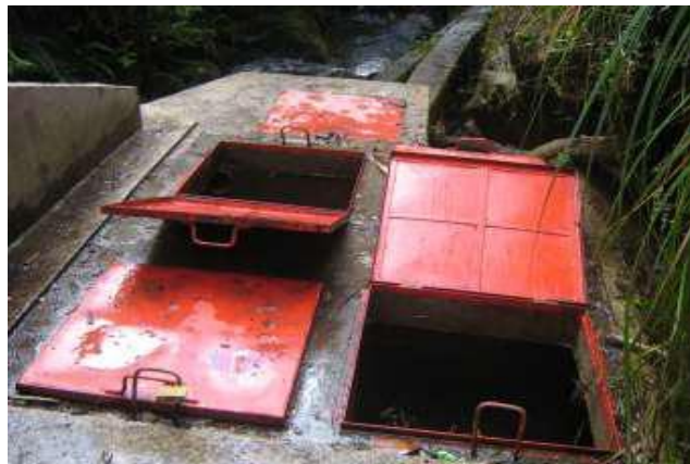
Fotografía 9. Cámaras de derivación bocatoma acueducto la Magdalena
