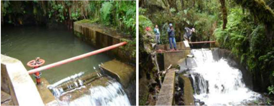
Fotografía 6. Bocatoma de fondo acueducto la Magdalena
