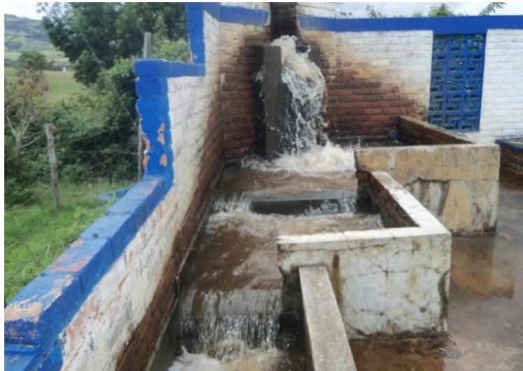
Fotografía 13. Cámara de llegada
